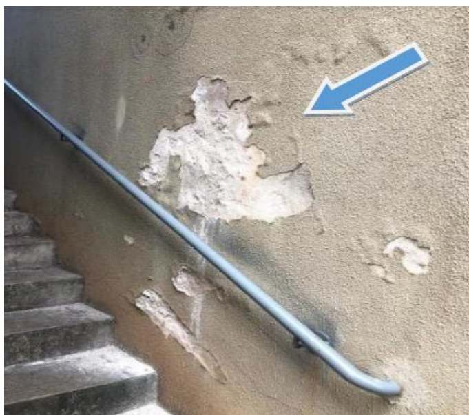
Figura 8 - Descolamento em parede.
