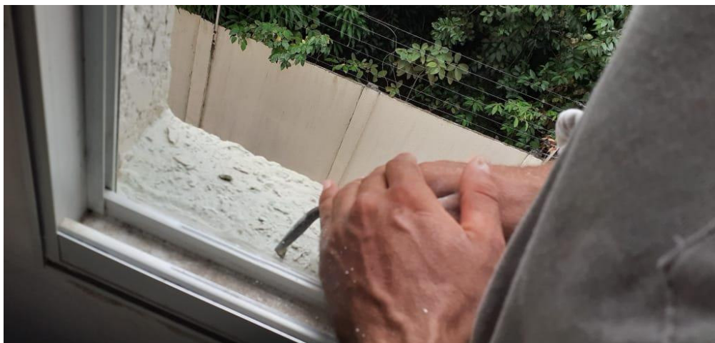
Figura 18 - Retirada do acabamento externo e silicone desgastado
