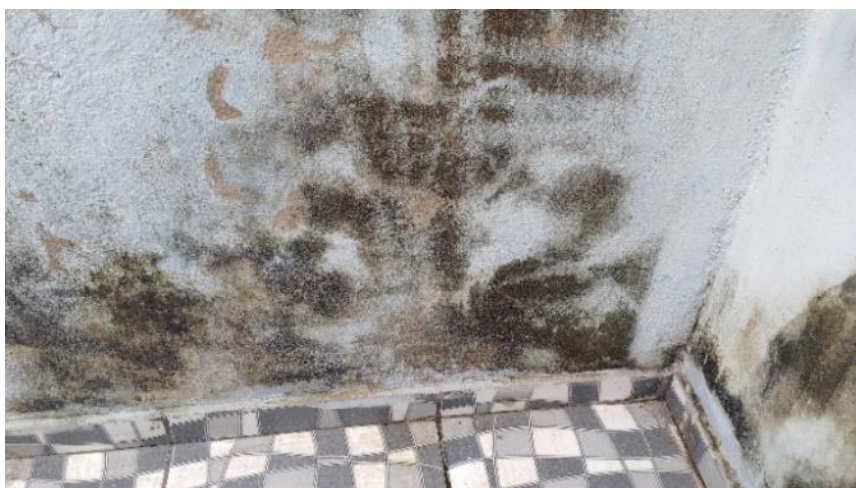
Figura 5 - Manchas ocasionadas pela infiltração da chuva.
