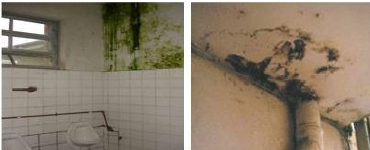
Figura 6 - Bolor e Mofo em Condomínio.
