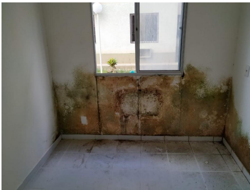
Figura 35 – Bolor e mofo no quarto
