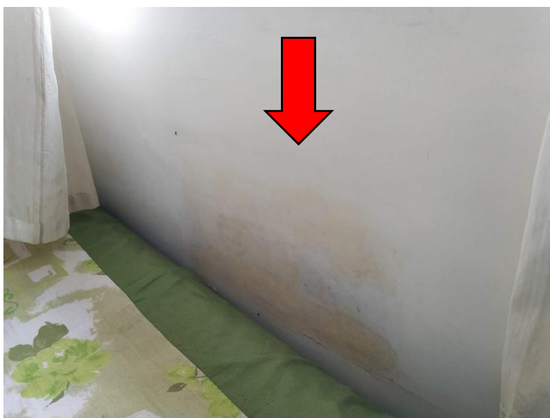
Figura 20 – Mancha infiltração no vão do ar condicionado
