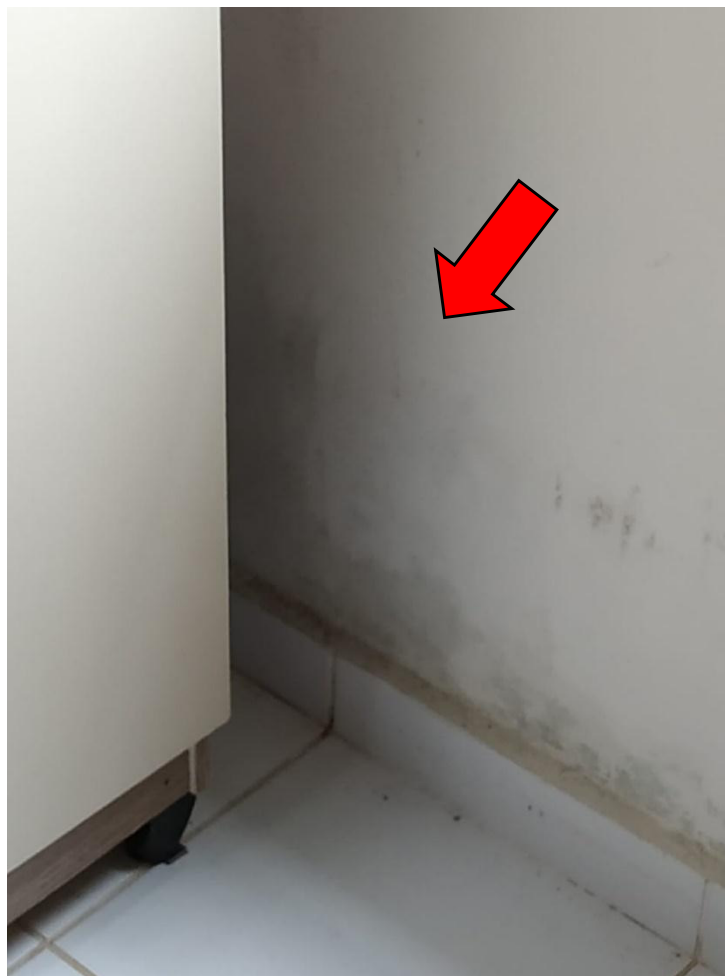
Figura 17 – Mancha de infiltração no quarto
