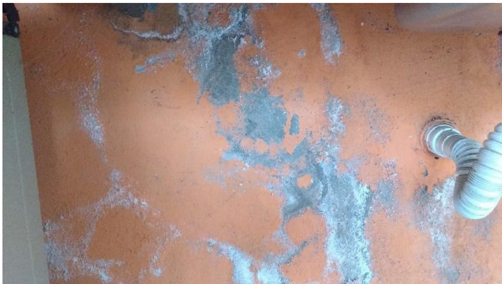
Figura 7- Eflorescência em edificação
