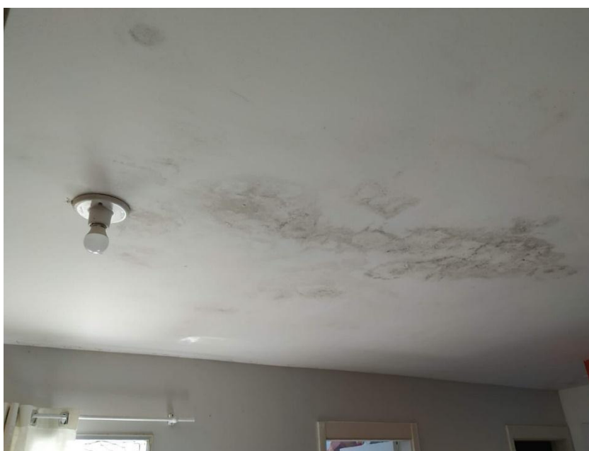
Figura 24 - Mancha teto da sala
