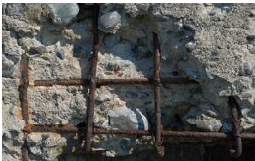
Figura 9 - Corrosão do Aço.
