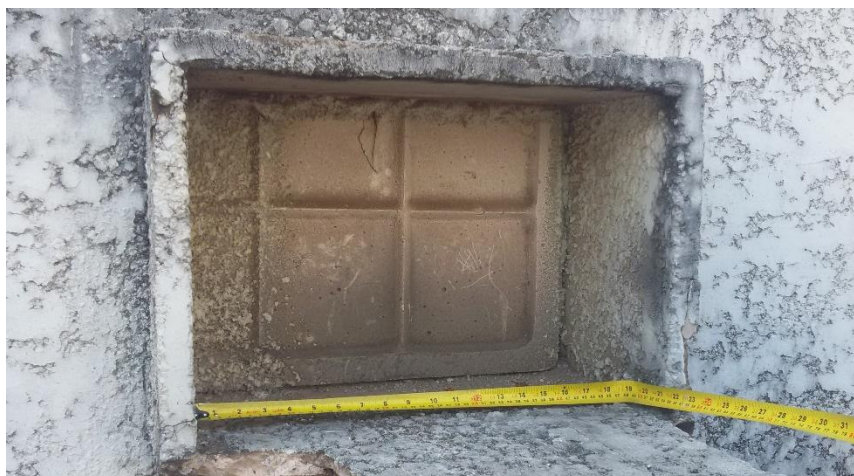
Figura 21 – Placa gesso do ar condicionado
