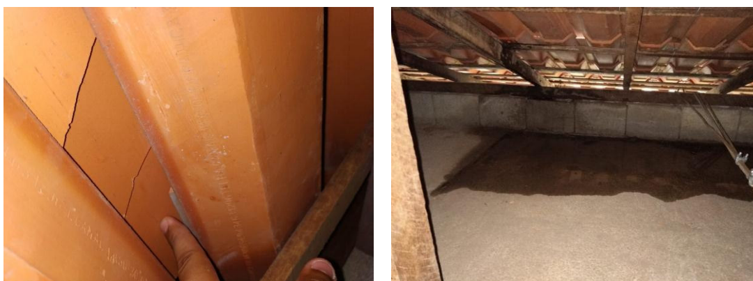
Figura 25 – Água acumulada devido a telha quebrada
