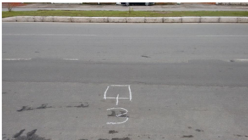
Figura 30: Patologias na Avenida Daniel de La Touche – Remendo
