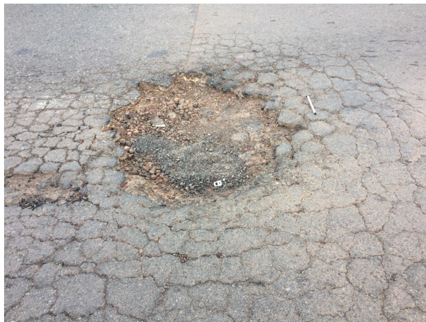
Figura 24: Patologias na Avenida Daniel de La Touche – Panela
