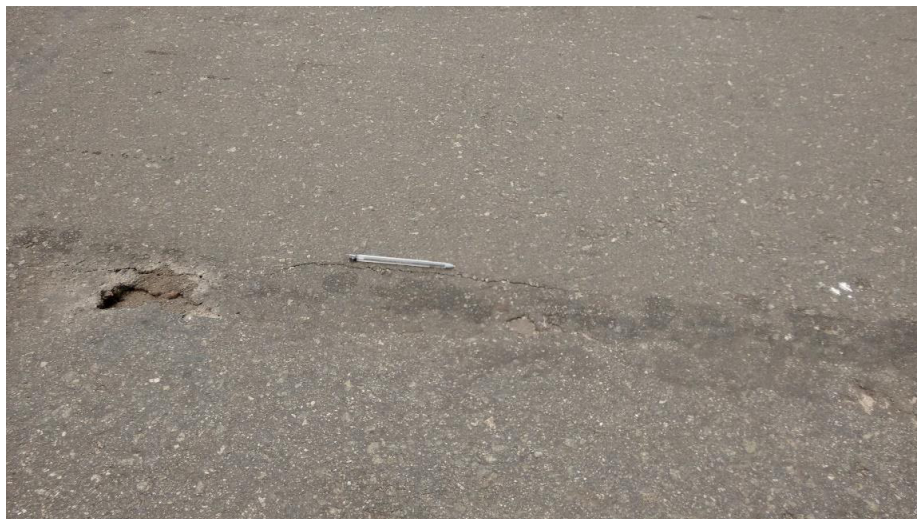
Figura 27: Patologias na Avenida Daniel de La Touche – Desgaste
