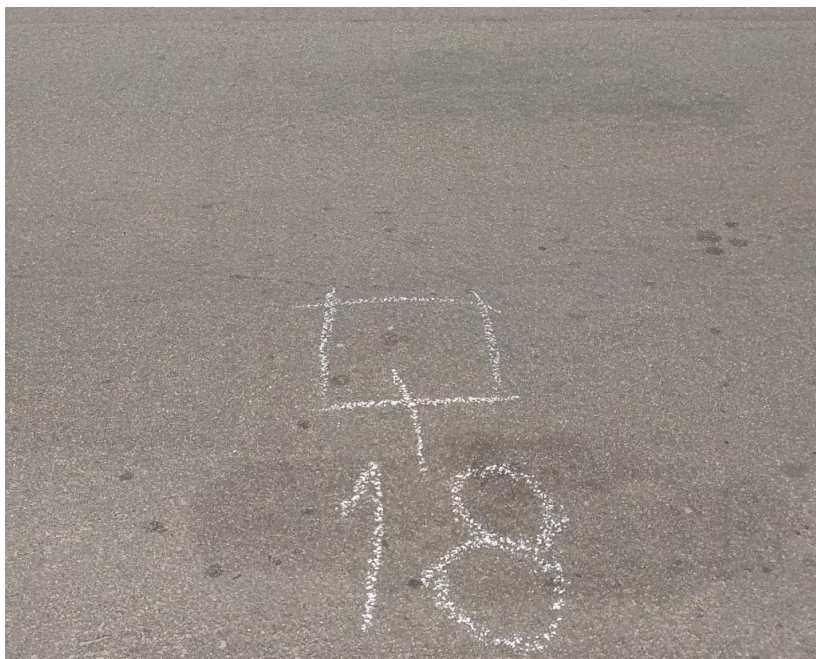
Figura 26: Patologias na Avenida Daniel de La Touche – Exsudação
