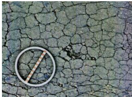
(b) Trincas tipo couro de jacaré sem erosão (J)
