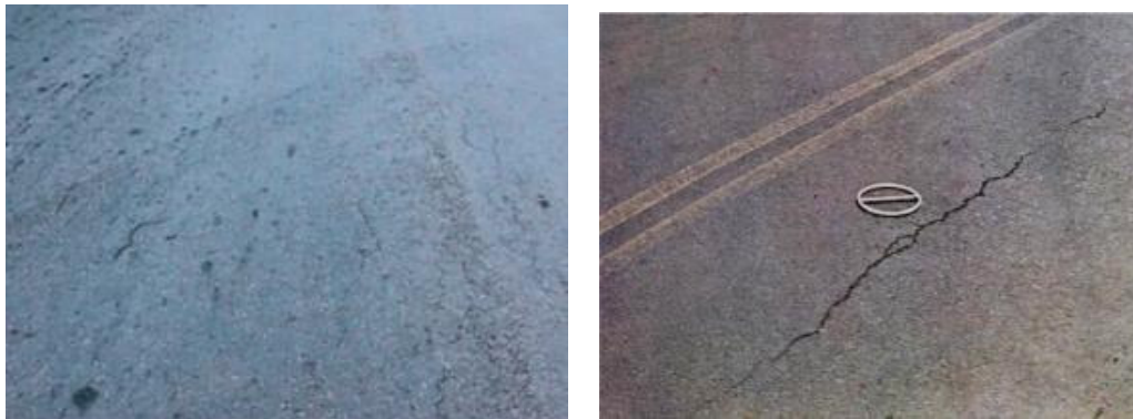
(a) Trinca Longitudinal curta (TLC)
