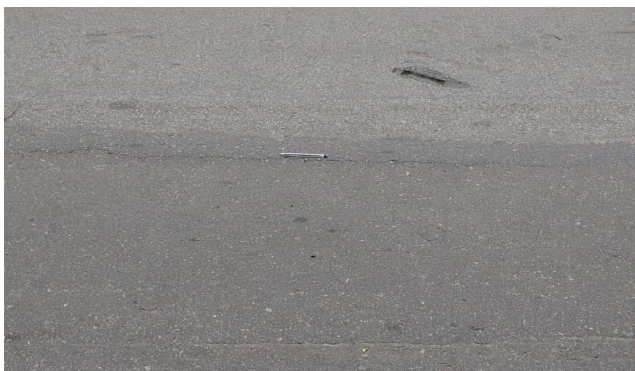
Figura 25: Patologias na Avenida Daniel de La Touche – Afundamento Plástico na trilha de Roda
