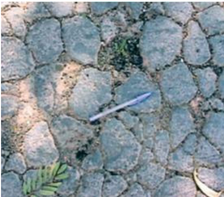
(a) Trincas tipo couro de jacaré com erosão (JE)
