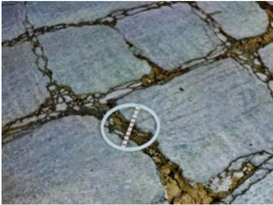
(a) Trincas de bloco com erosão (TBE)
