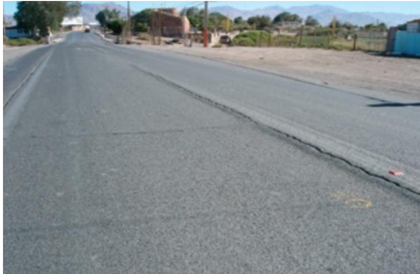
Figura 8: Trinca de retração (TRR)
