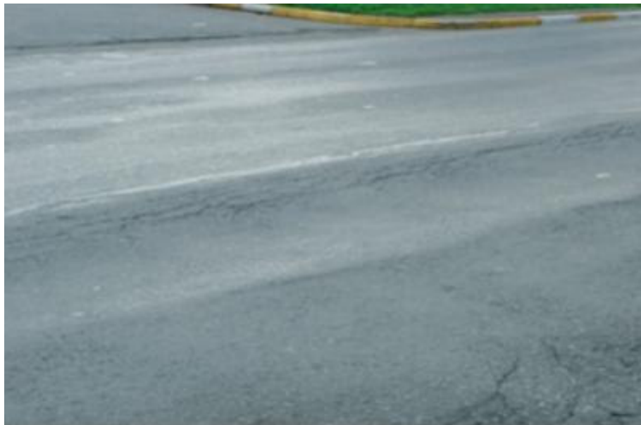
Figura 12: Afundamento plástico das trilhas de roda (ATP)
