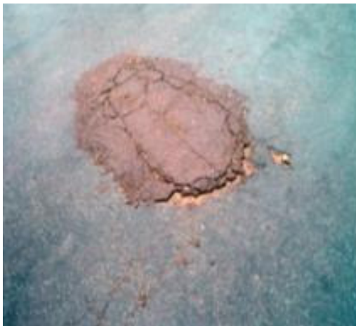
(a) Remendo (má execução)
