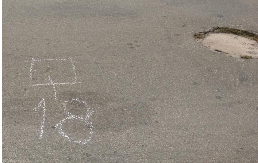
Figura 23: Patologias na Avenida Daniel de La Touche – Rede subterrânea de água e esgoto
