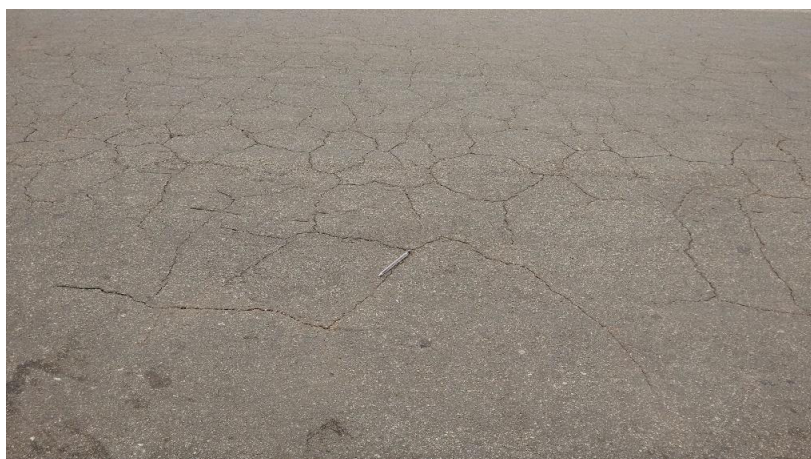
(b) Trinca tipo couro de jacaré
