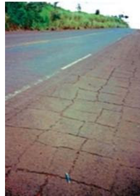
(b) Trincas de bloco sem erosão (TB)
