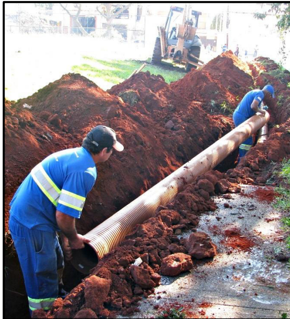
Figura 10 - Tubulação de PVC
