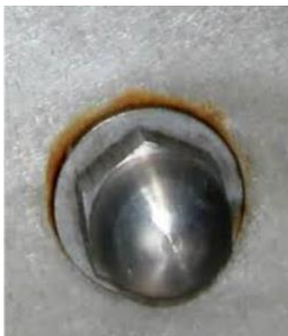
Figura 7 – Corrosão em fresta sob cabeça de parafuso.
