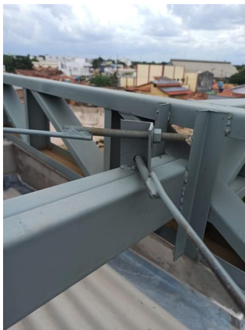
Figura 21 – Contraventamentos com corrosão (anomalia endógena).
