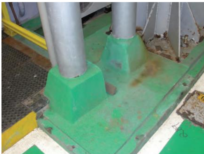
Figura 6 - Pilares sofrendo corrosão na região de maior perda de seção.
