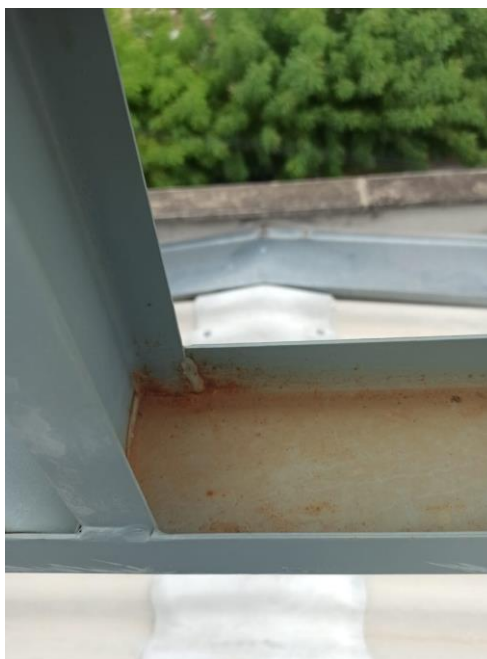
Figura 20 - Perfil U simples de treliça com presença de corrosão (anomalia endógena).
