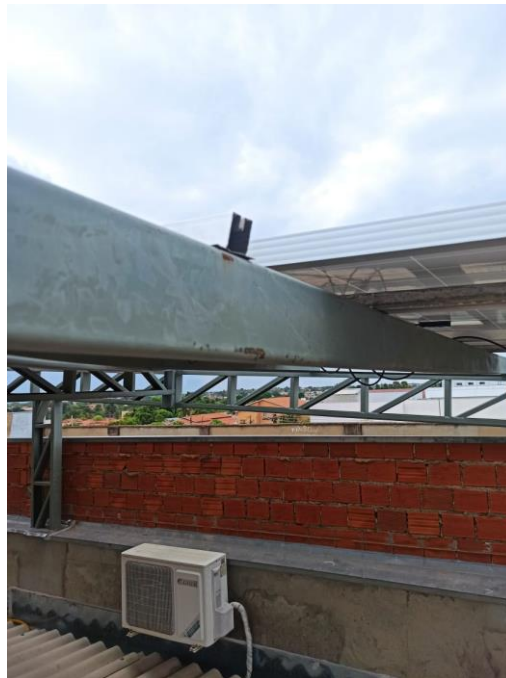
Figura 19 - Perfil U enrijecido com presença de corrosão (anomalia endógena).
