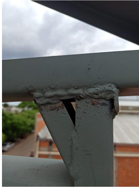
Figura 18 - Perfil U simples com presença de corrosão (anomalia endógena).
