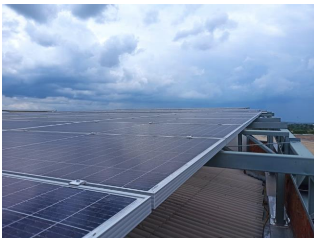
Figura 11 – Estrutura metálica e painéis fotovoltaicos sobre telhado de fibrocimento.
