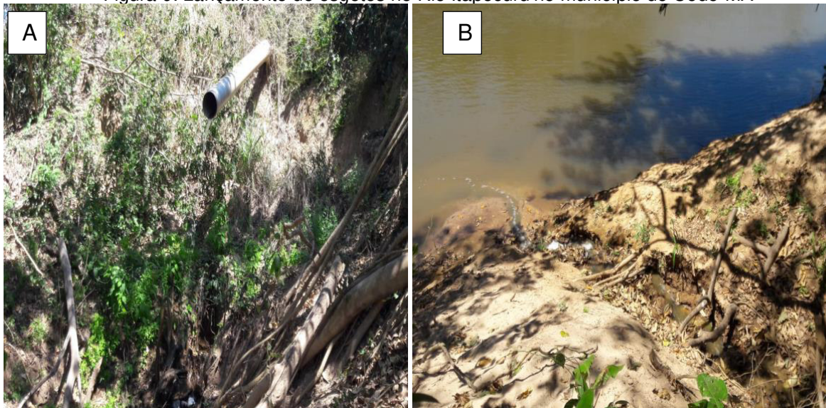
Figura 9: Lançamento de esgotos no Rio Itapecuru no município de Codó-MA
