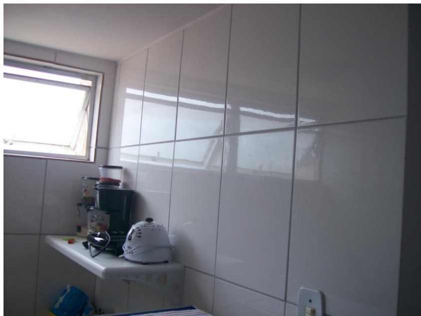
Foto 16 - Eletrodomésticos em locais inapropriados
