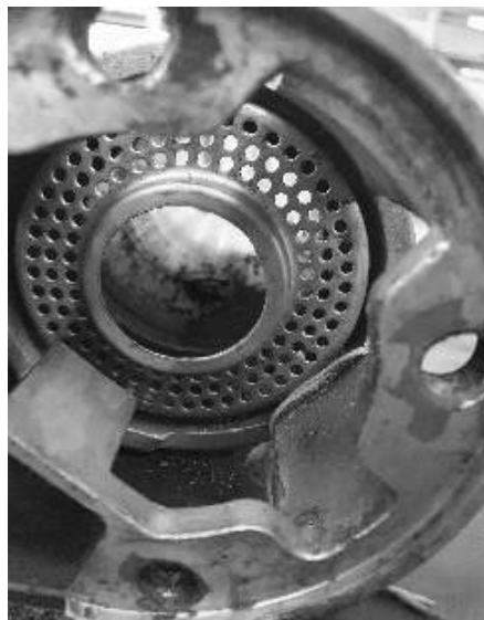
Figura 22 – Filtro peneira da bomba sem a presença de material sólido.
