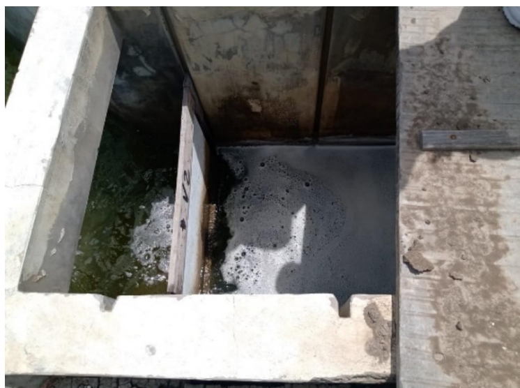
Figura 17. Comporta de despesca contendo a tela para impedir a passagem dos camarões.
