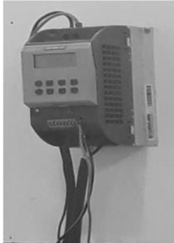
Figura 4.3 – Inversor de Frequência
