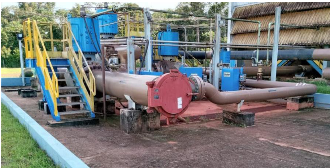
Figura 8 – Canhão lançador de PIG, estação de bombeamento 2.
