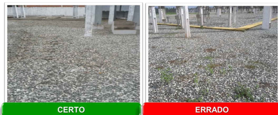
Figura 5.15 – Aplicação do senso de limpeza no pátio da SE Maracanã ao fazer a retirada do mato
