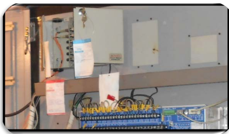
Figura 5.8 – Etiquetas do TPM no disjuntor 11C2 da SE MAR
