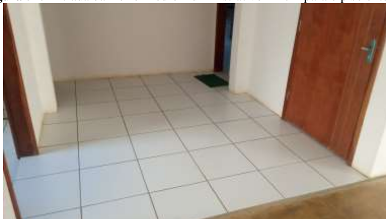
Figura 51: Entrada banheiro Prédio Administrativo + 2cm para o piso externo.
