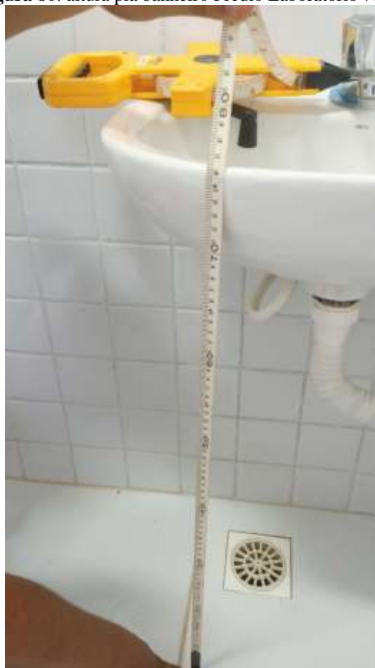
Figura 80: altura pia banheiro Prédio Laboratório 76cm.
