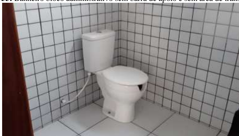
Figura 55: Banheiro bloco administrativo sem barra de apoio e sem área de transferência.
