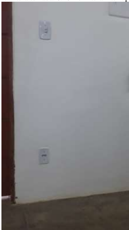
Figura 101: Altura tomada: 0.40m e Altura interruptor: 1.27m.
