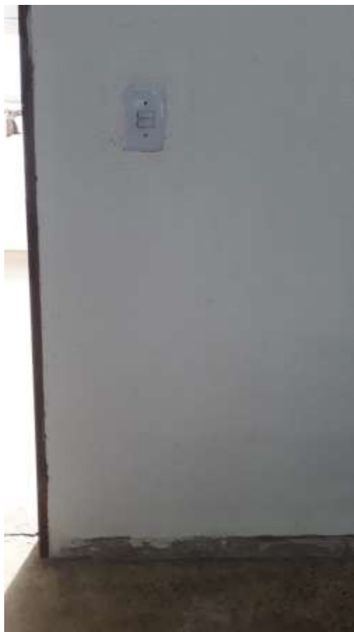
Figura 17: Altura interruptor salas prédio pedagógico: 1.19m.
