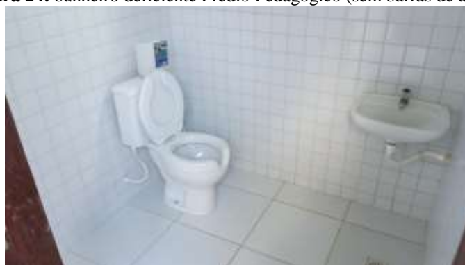
Figura 24: banheiro deficiente Prédio Pedagógico (sem barras de apoio).
