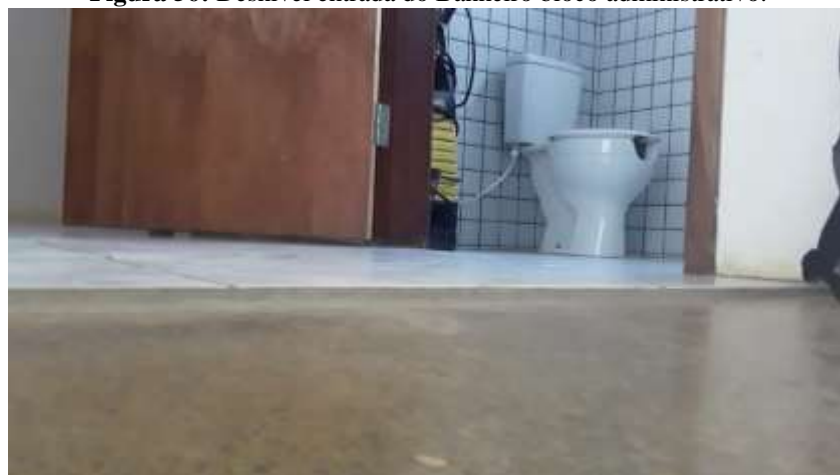
Figura 56: Desnível entrada do Banheiro bloco administrativo.
