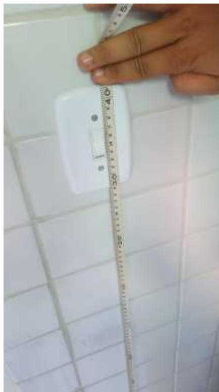
Figura 23: Altura interruptor banheiro deficiente Prédio Pedagógico 1,35m.
