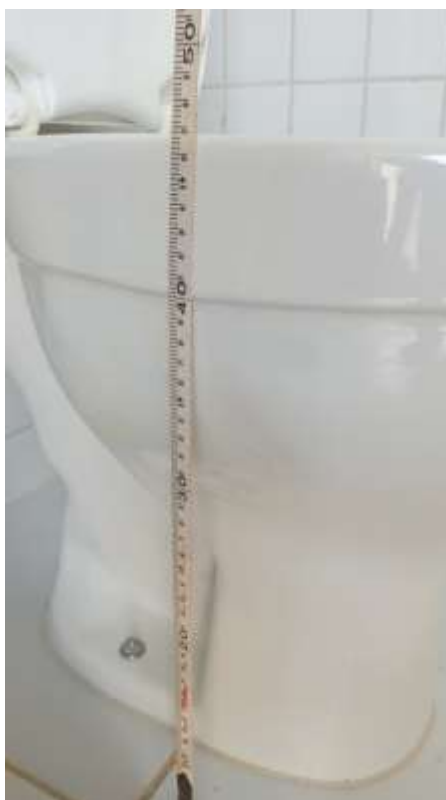
Figura 22: Vaso banheiro deficiente Prédio pedagógico 47cm.
