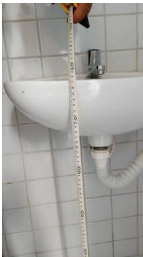
Figura 21: altura da pia banheiro deficiente Prédio pedagógico: 0,77m.
