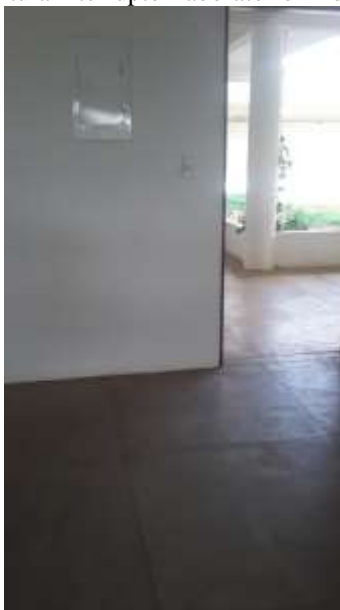
Figura 103: Altura interruptor laboratório informática: 1.30m
