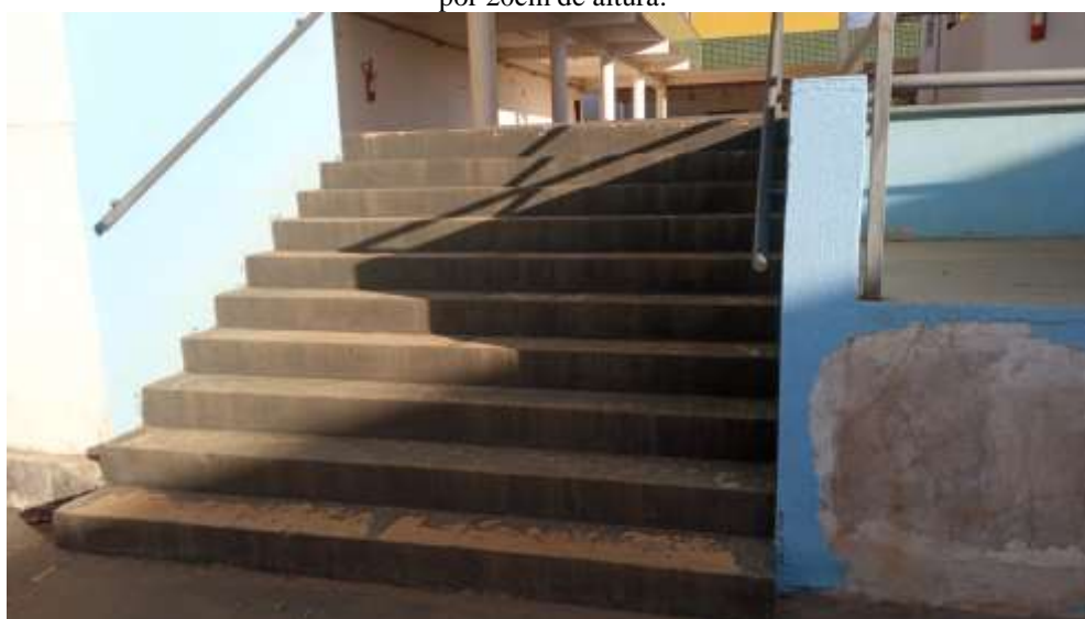
Figura 42 Escada 1 Prédio Pedagógico 1,84 de altura x 2,52 de comprimento x 10 degraus de 31cm de largura por 20cm de altura.
