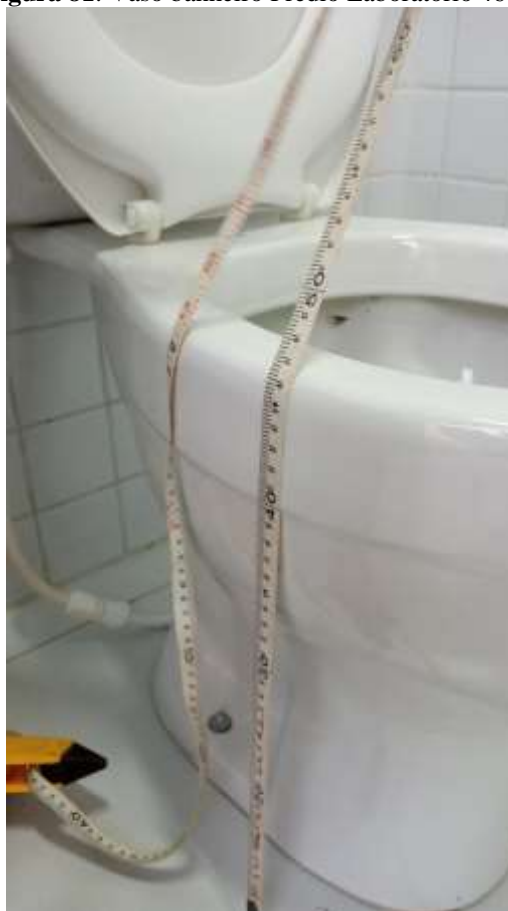
Figura 81: Vaso banheiro Prédio Laboratório 46cm
