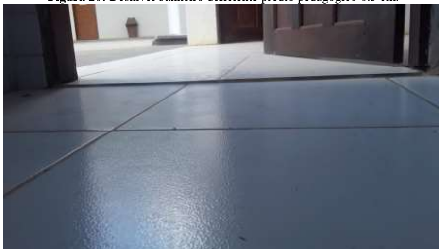
Figura 20: Desnível banheiro deficiente prédio pedagógico 0.5 cm.
