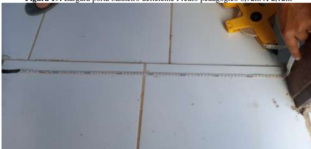
Figura 19: Largura porta banheiro deficiente Prédio pedagógico 0,92m X 2,12m
