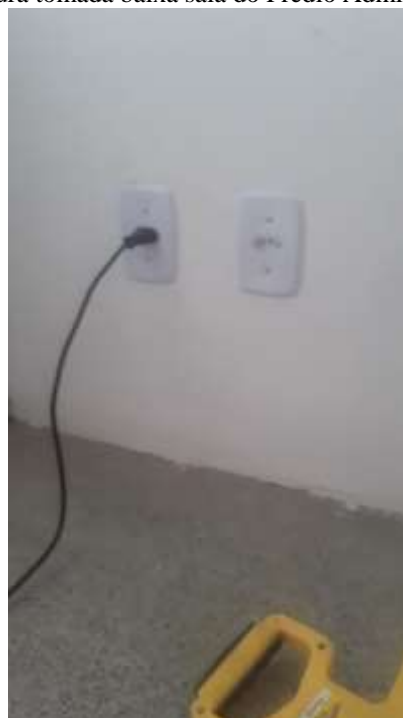
Figura 61: Altura tomada baixa sala do Prédio Administrativo: 33cm.
