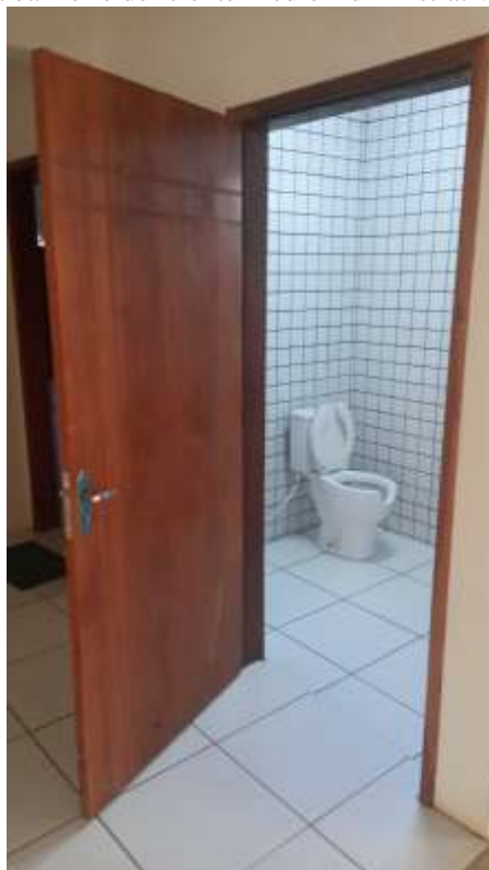
Figura 57: Entrada banheiro deficiente Prédio Administrativo porta 2,08 x 0,9m.
