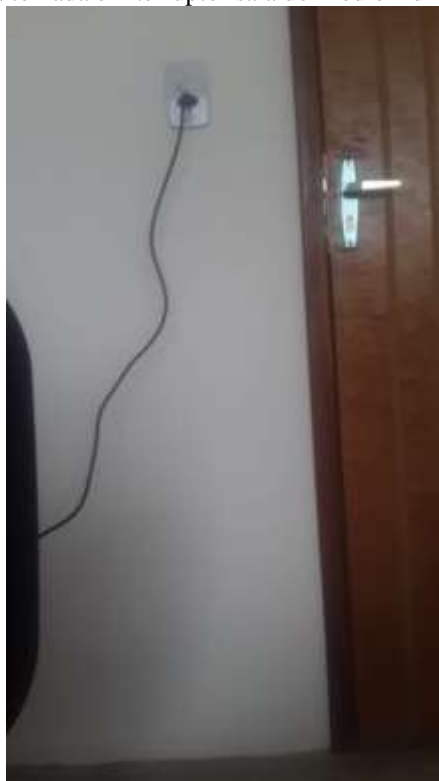
Figura 60: Altura tomada e interruptor sala do Prédio Administrativo: 1.30m.
