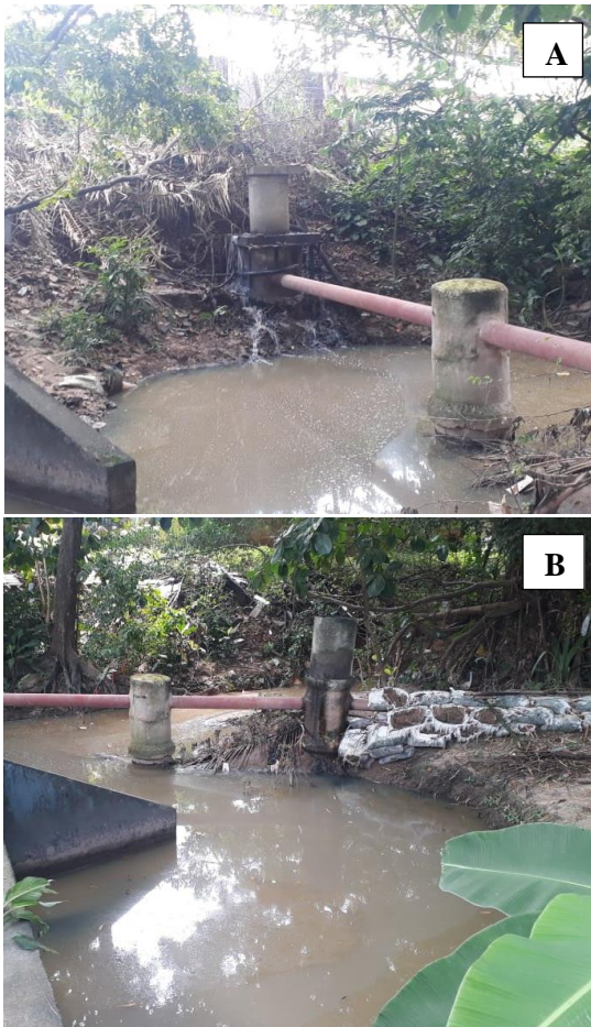
Figura 12. As imagens A e B demonstram vazamento de esgoto in natura na região do médio curso do rio Pimenta.
