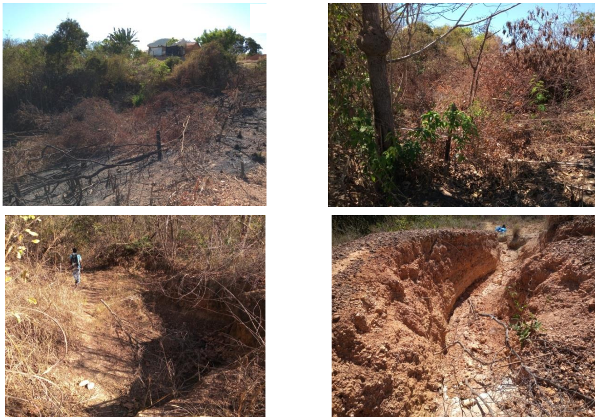
Figura 4: Áreas degradadas ou em processo de degradação, próximas ao rio das Balsas, bairro Trizidela, Balsas, Maranhão.
