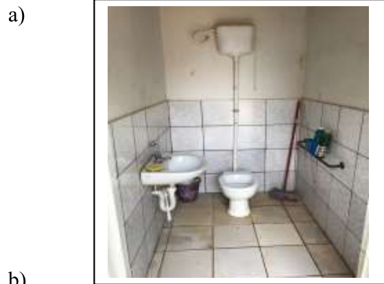
Figura 22: Barras de apoio do sanitário acessível da escola a) e os da norma b).
