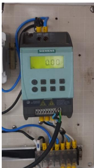
Figura 14 – Inversor de frequência.
