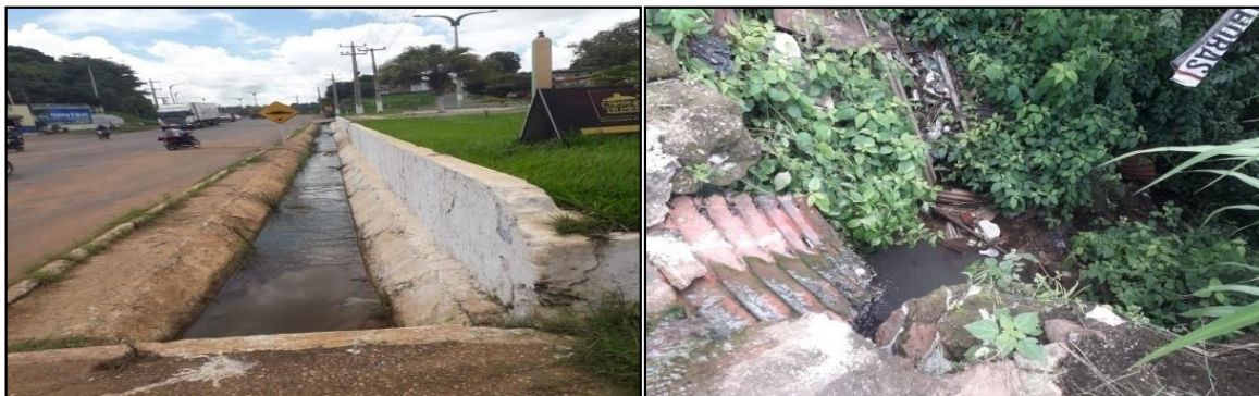
Figura 03. Esgoto doméstico e comercial drenado até o rio direto debaixo da ponte de cimento no centro. Fonte: Acervo particular.
