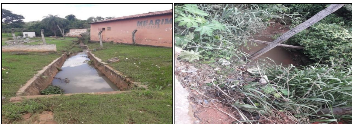
Figura 04. Esgoto rua Antonio Teles vila Viana. Fonte: Acervo particular.
