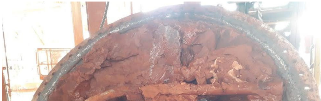
Figura 19: Tampa de saída de um lavador com sinais de incrustação. Fonte: Adaptado por autora (2022).
