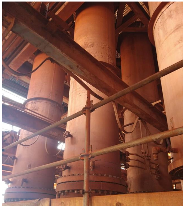
Figura 23: Disposição dos trocadores de calor em bancada. Fonte: Adaptado por autora (2022).
