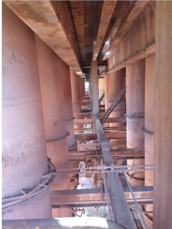
Figura 24: Bancada de trocadores de calor. Fonte: Adaptado por autora (2022).
