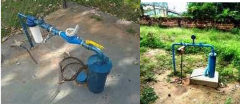
Figura 4: Torneira/cavalete de poço
