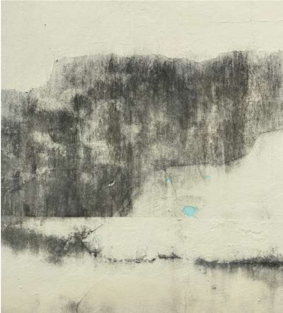
Manchas de bolor e descolamento de pintura
