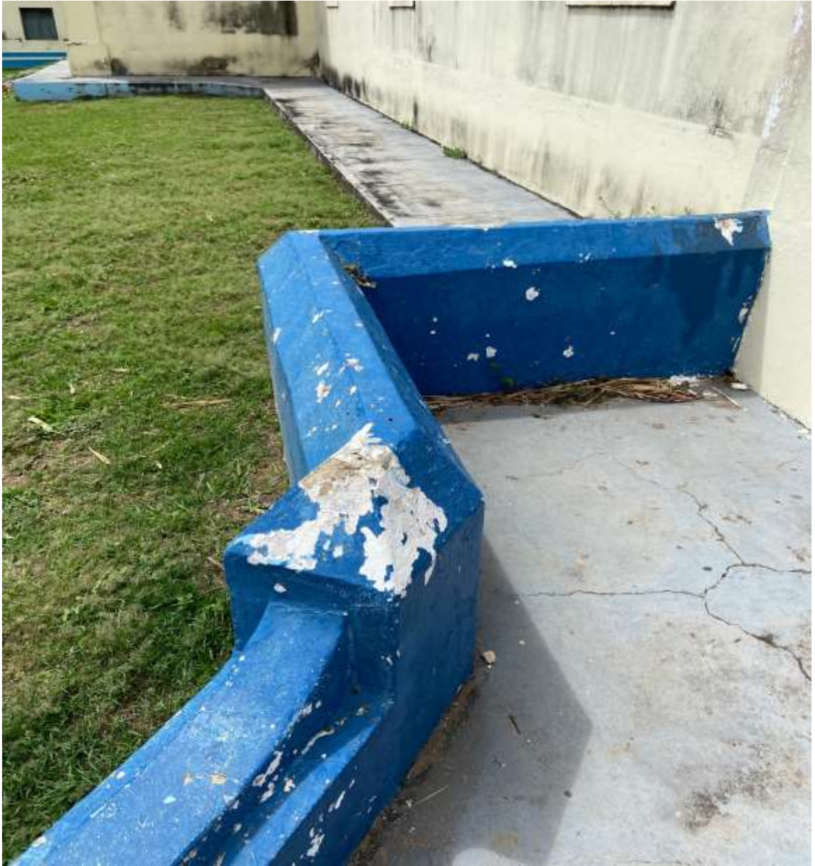
Descolamento de pintura
