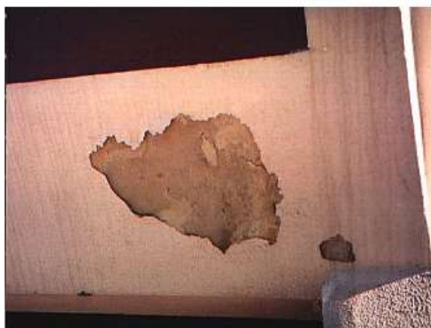
Figura 7 - Descolamento da Tinta de Revestimento
