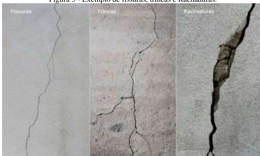
Figura 5 - Exemplo de fissuras, trincas e Rachaduras.
