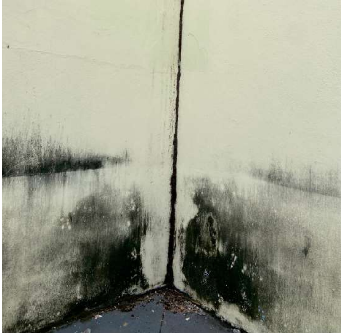
Manchas de bolor
