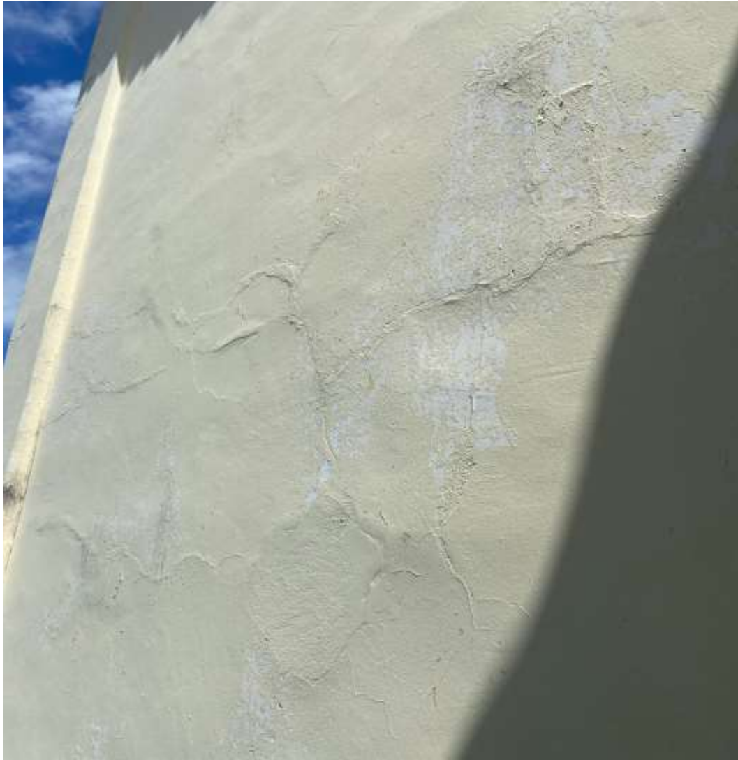
Reincidência fissuras mapeadas
