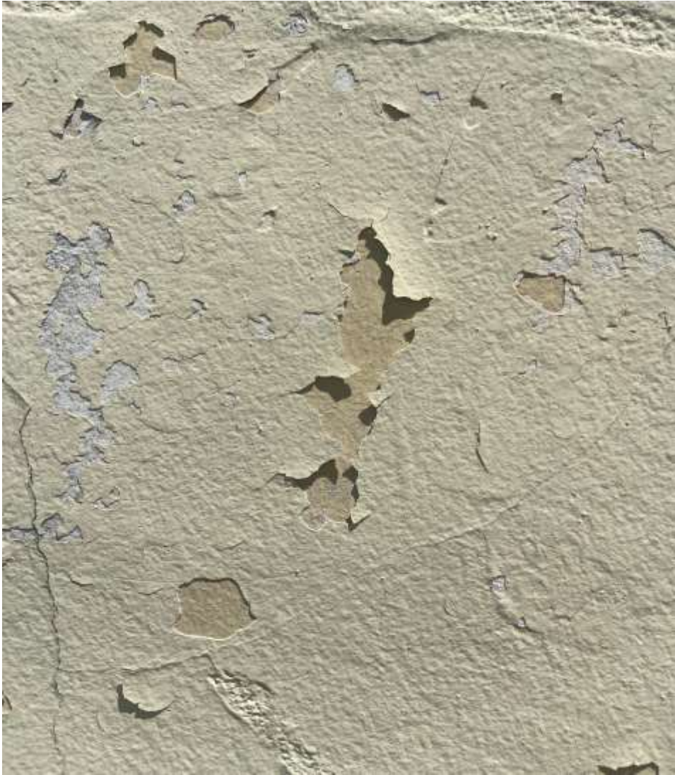
Descolamento de pintura
