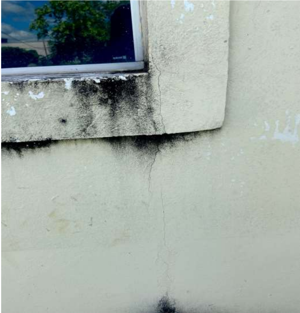
Descolamento de pintura
