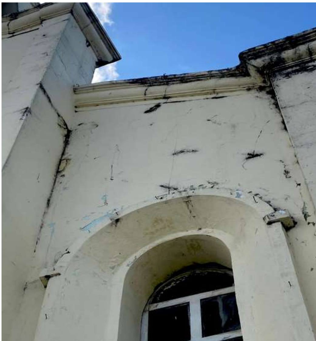
Manchas de bolor fachada frontal
