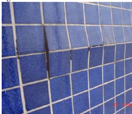
Figura 4 - Descolamento de revestimento
