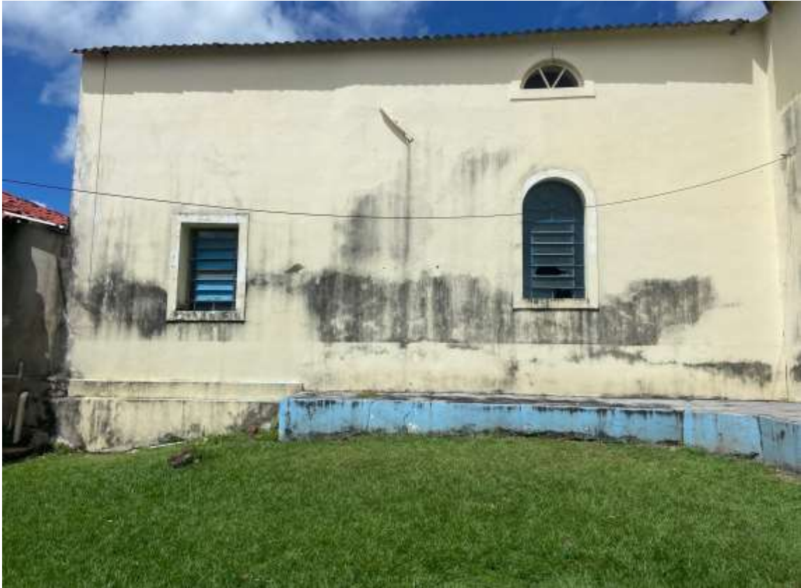
Manchas de bolor
