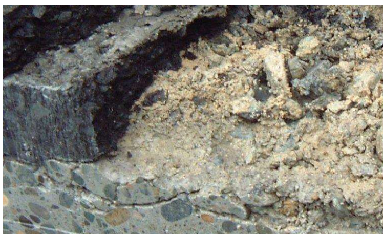
Figura 7: Deterioração do concreto.
