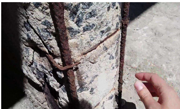
Figura 5 – Corrosão armadura de um pilar.
