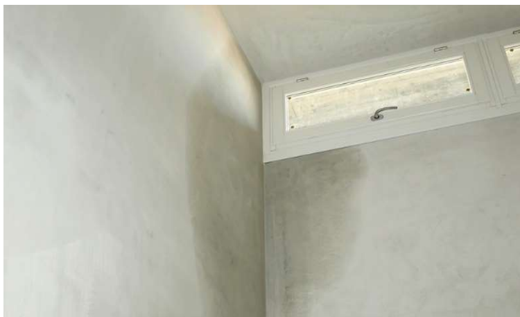
Figura 12: Mancha de umidade na parede.
