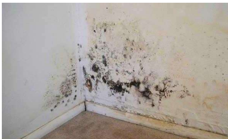
Figura 11 - Bolor em parede.
