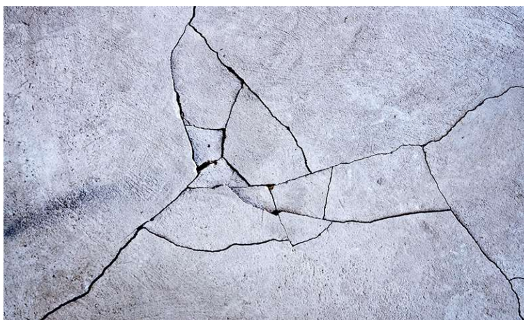
Figura 6: Desagregação e fissura no concreto.
