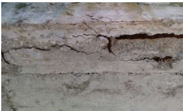
Figura 4 – Degradação estrutura de concreto.
