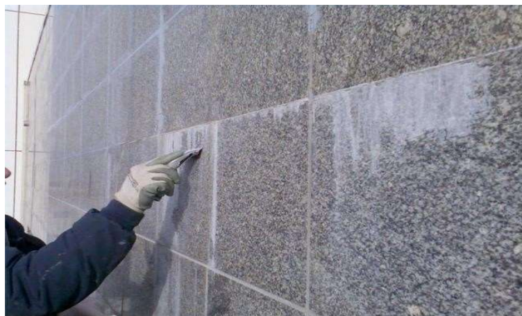
Figura 10 - Sais solúveis na superfície da parede (eflorescência).
