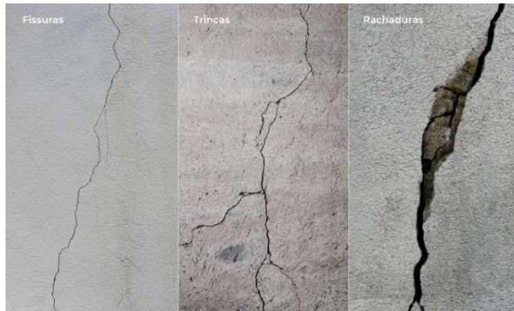
Figura 9: Manifestação de fissuras, trincas e rachaduras.
