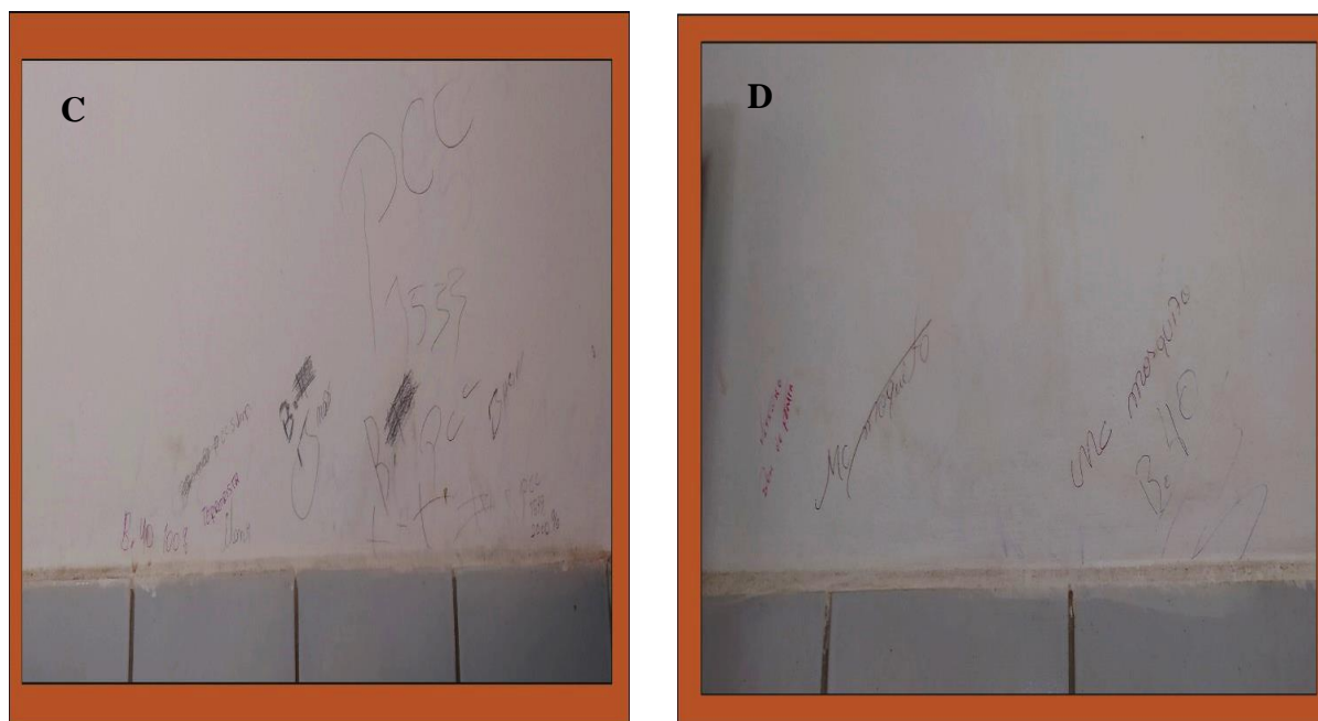
Figura 9 – Pichações na escola Governador João Castelo localizada no bairro Morada Nova.
