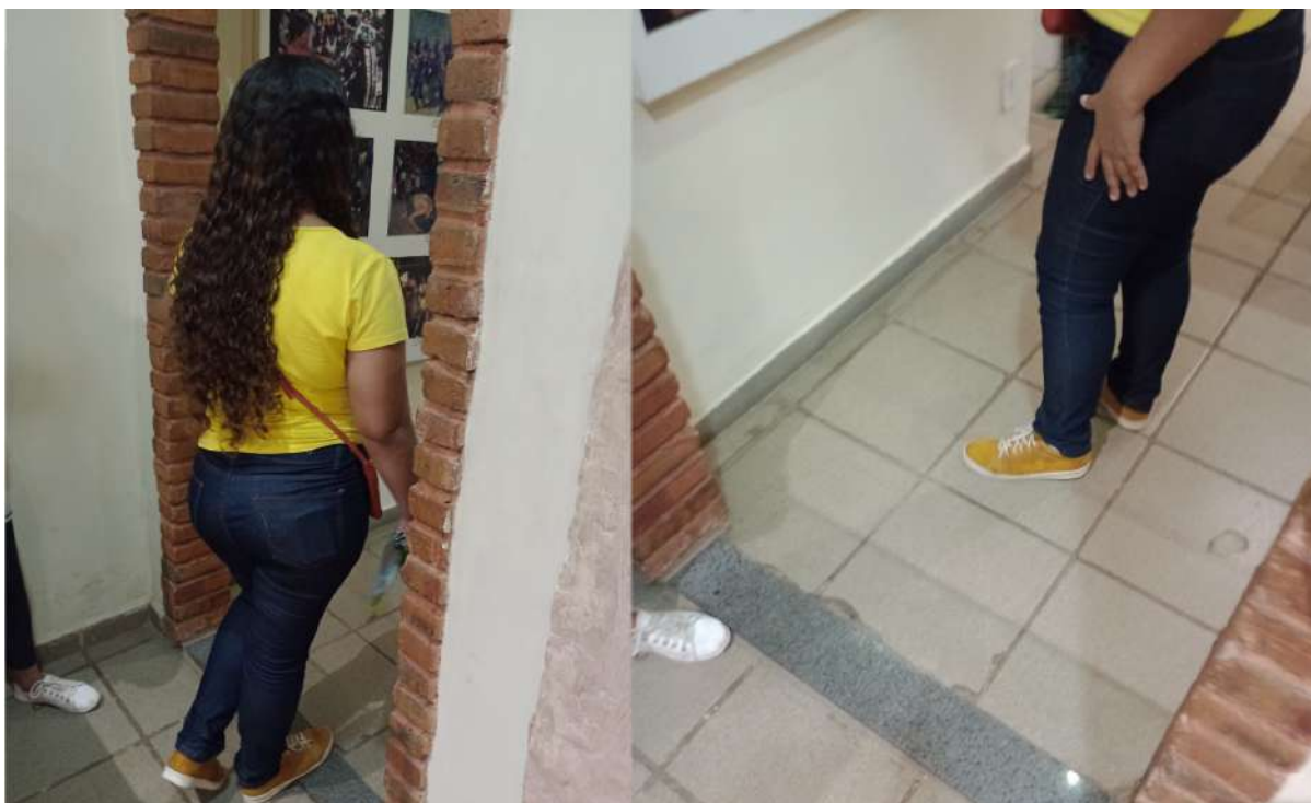
Figura 33: Imagem que mostra desnível entre salas.
