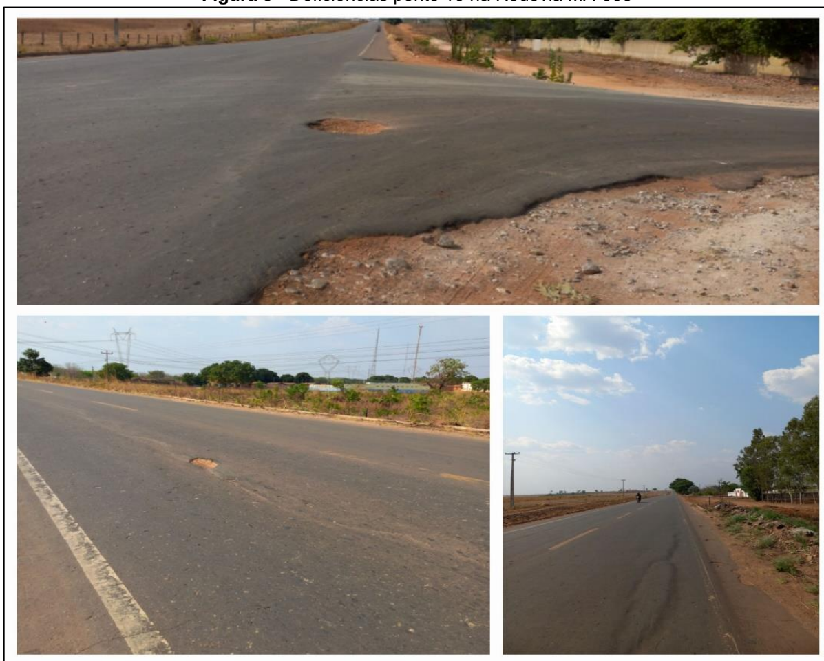
Figura 5 - Deficiências ponto 10 na Rodovia MA-006
