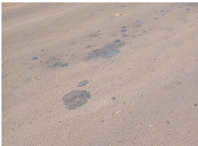
Figura 53 – Derramamento de óleo da seção 21.
