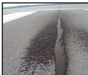
Figura 14 - Trincas de borda.
