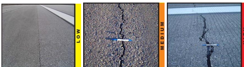
Figura 16 - Trincas longitudinais e transversais.
