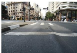
Figura 10 - Elevações e recalques.
