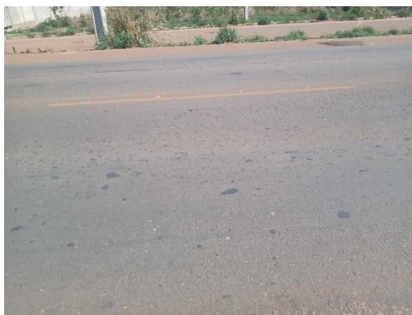
Figura 31 – Escorregamento de massa da Seção 2.
