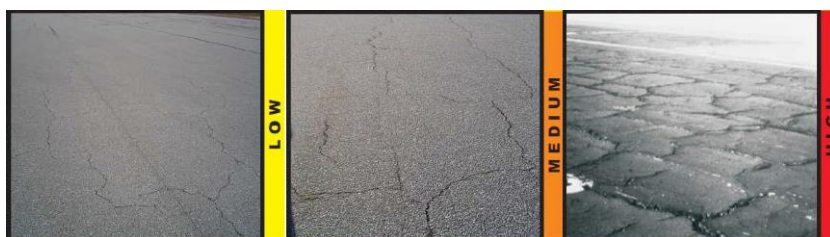
Figura 9 - Fissuras em Bloco.
