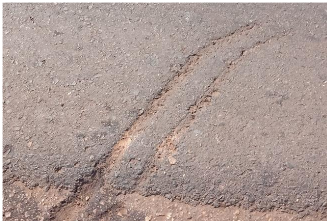
Figura 39 – Afundamento localizado da Seção 6.
