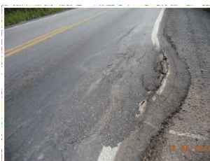
Figura 20 – Escorregamento de massa.
