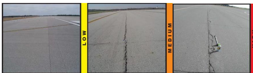
Figura 15 – Trincas por reflexão de juntas.
