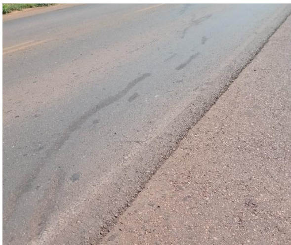
Figura 41 – Recalques na seção 20.
