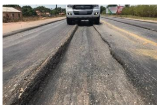
Figura 13 - Afundamento de trilha de roda.
