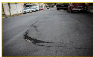
Figura 21 – Fissuras devido ao escorregamento de massa.
