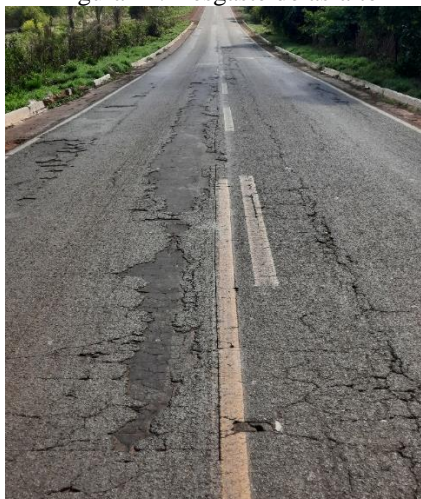
Figura 11. Desgaste do asfalto
