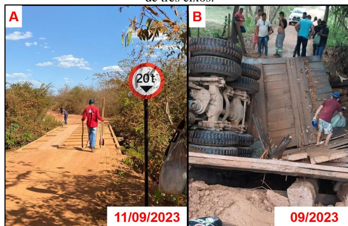
Figura 1 – À esquerda, uma placa limitando o peso máximo. À direita, colapso da ponte causado por um caminhão de três eixos.
