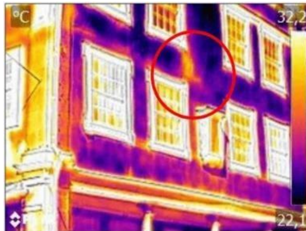
Figura 14: Termografia de fachada de prédio histórico
