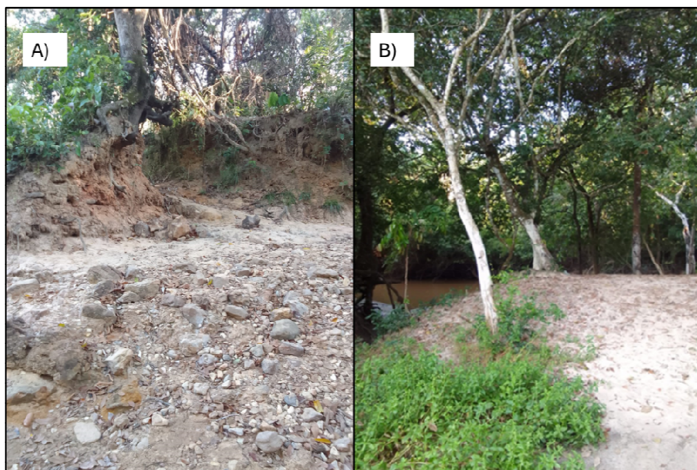
Figura 7. Margem do Rio Saco com presença de erosão e redução de mata ciliar. Fonte: Produção da autora.
