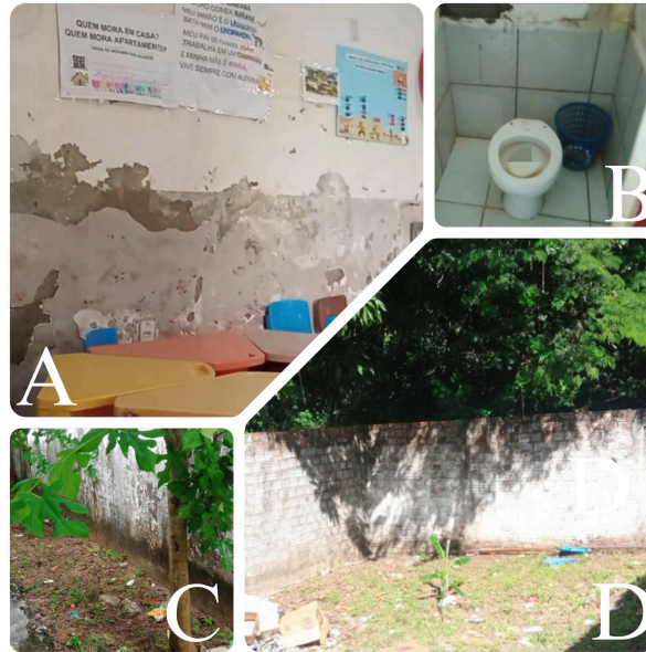
Figuras 4. Registros realizados no local de trabalho da Quebradeira de coco babaçu durante entrevista, no dia 24 de maio de 2024. As imagens A e B (imagem censurada devido a falta de limpeza) mostram problemas na infraestrutura da escola, como o desgaste na pintura (A) e a falta de condições mínimas de higiene e segurança (B) em um dos banheiros usados pelas crianças. A imagem C mostra o local onde foi desenvolvido o projeto de horta na escola, atualmente, desativada. A imagem D mostra o local no quintal da escola onde é realizado a queima de lixo. Fonte: Acervo da pesquisadora, 2024.
