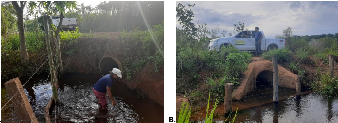
Figura 10. Manilhas de passagem d'água sob estrada vicinal nos pontos 9 e 10.
