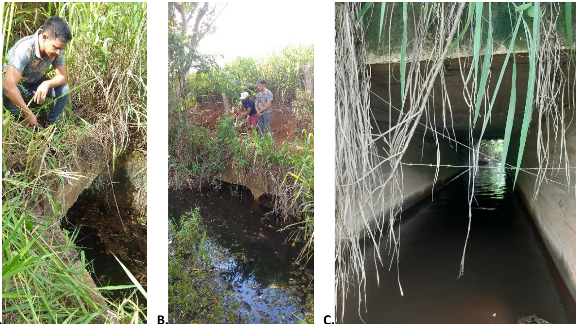
Figura 3. Galerias com passagem de água situadas abaixo da BR-226 nos pontos 2 (A), 3 (B) e 4 (C).
