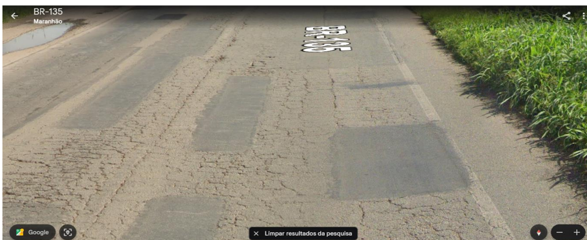
Figura 2: Avarias na via de acesso ao CGA. – TITARA (BR 135).
