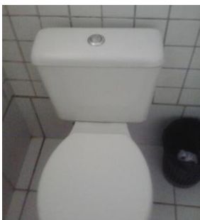
Figura 11 - Vaso sanitário utilizado no CPPF
