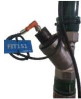
Figura 14 – Medidor de vazão.
