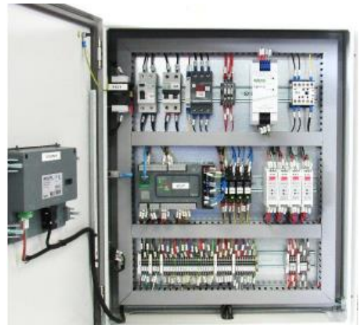
Figura 12 – Vista interna do painel.
