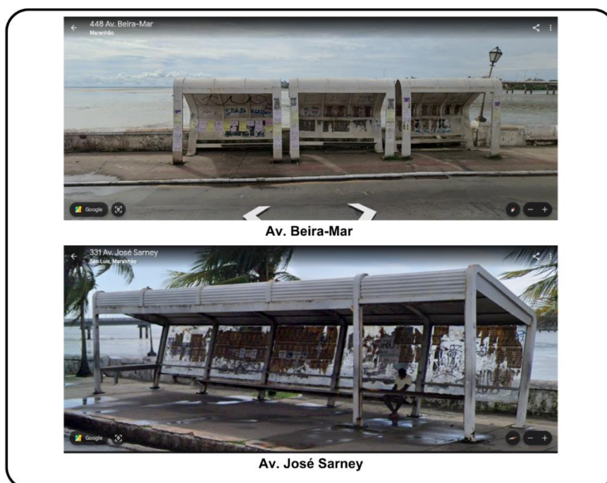
Figura 21 – Paradas de Ônibus Mal-conservadas na Capital: situadas próximas ao Museu Ferroviário do Maranhão e ao Palácio dos Leões em importantes avenidas da cidade
