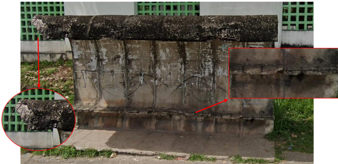
Figura 20 – Parada de Ônibus em Situação Precária na Capital: situada na área externa do Campus Dom Delgado, Cidade Universitária, UFMA
