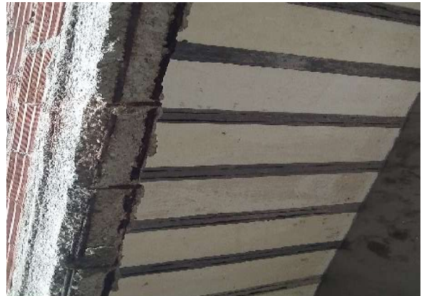
Figura 10 – corrosão de armadura.
