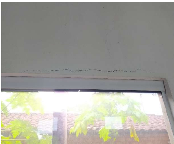
Figura 1 - fissura horizontal em janela
