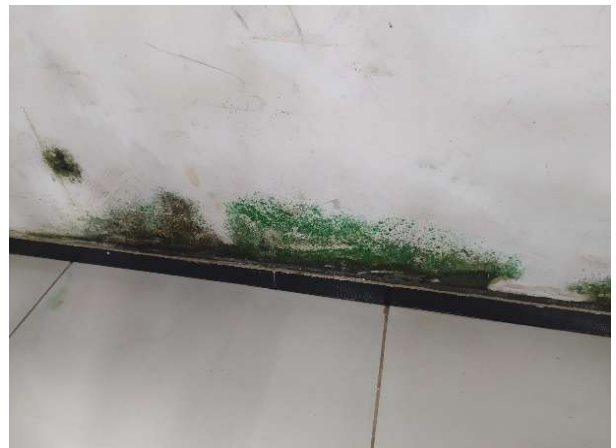
Figura 5 – mofo em estágio avançado
