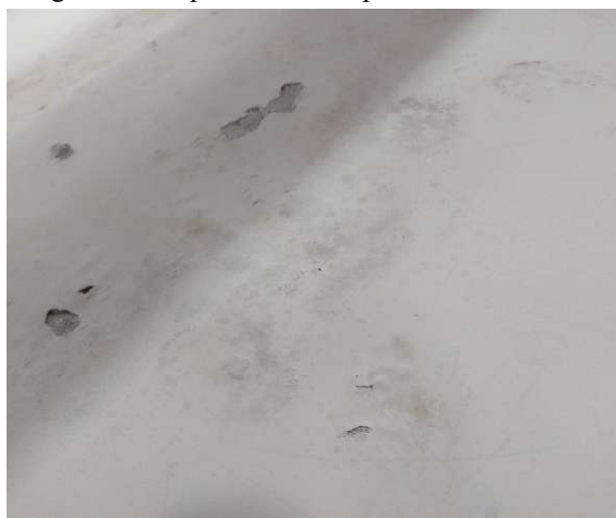
Figura 6 – empolamento em parede de alvenaria.
