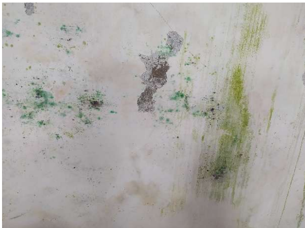
Figura 4 – mofo e bolor em parede
