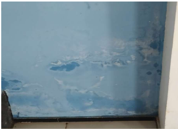
Figura 7 – eflorescência em alvenaria.
