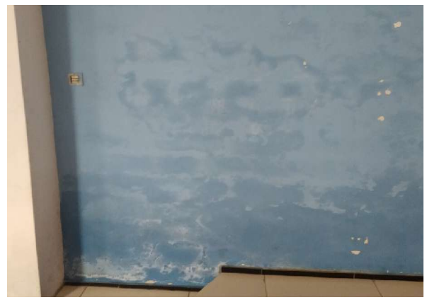
Figura 8 – eflorescência em alvenaria.
