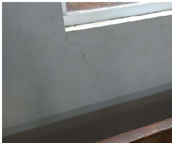
Figura 2 - fissura vertical em janela
