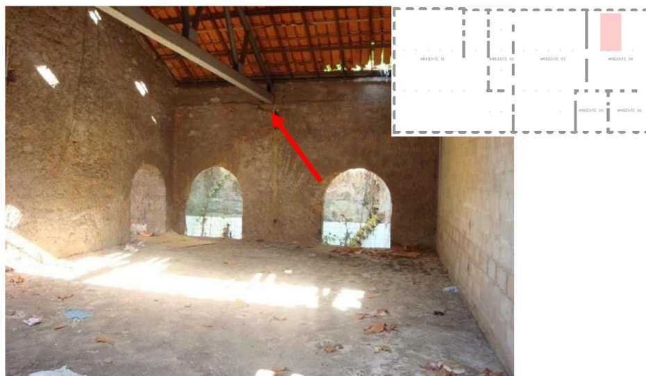
Figura 42 - Viga metálica de perfil diferente das demais – Ambiente 04
