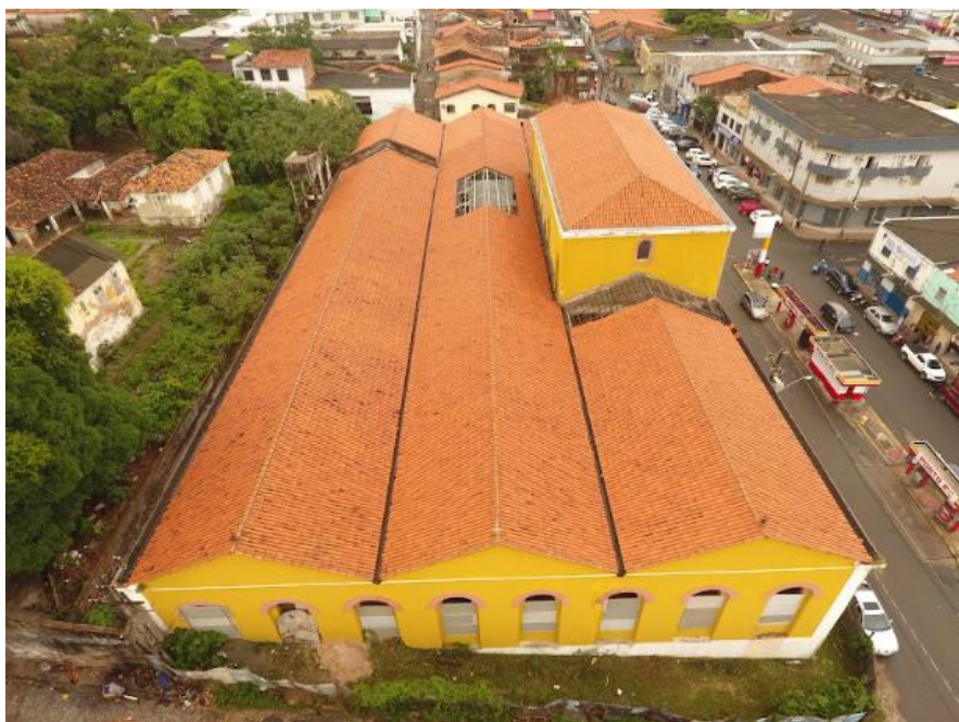
Figura 54 - Ambientes sem telhas na cobertura
