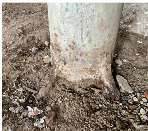
Figura 32 - Pilar apresentando oxidação na base
