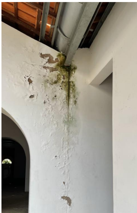
Figura 30 - Bolor em parede causado por vazamento na calha
