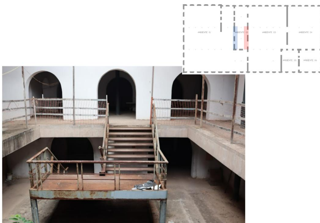
Figura 43 - Indício de abertura de vãos em parede entre ambientes 02 e 03
