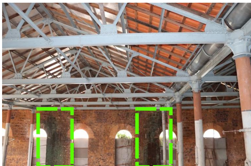
Figura 29 - Manchas de bolor – Ambiente 01
