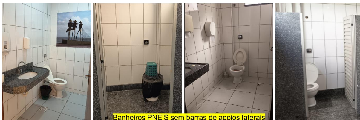
Figura 7 - Banheiros PNEs sem barra de apoio
