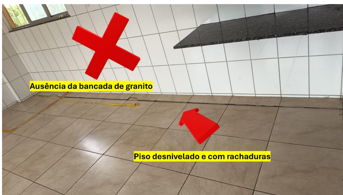
Figura 4 - Cozinha sem bancada e o piso com recalque
