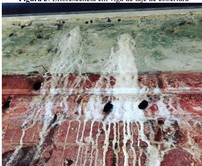
Figura 3: Eflorescência em viga de laje de cobertura
