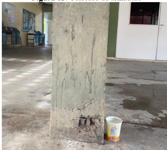
Figura 15: Corrosão da armadura
