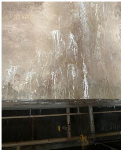
Figura 20: Eflorescência abaixo de reservatório
