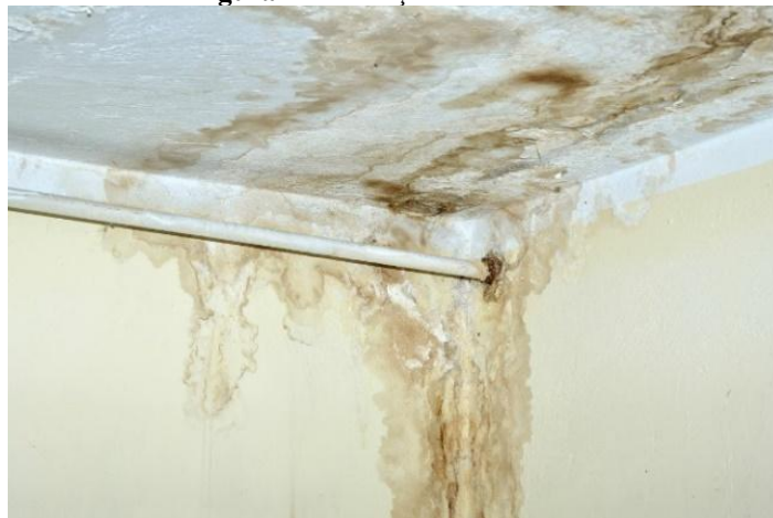
Figura 2: Infiltração em cobertura
