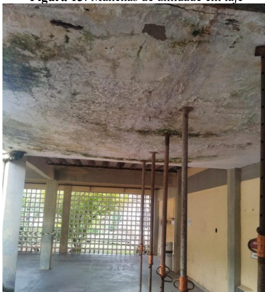
Figura 13: Manchas de umidade em laje
