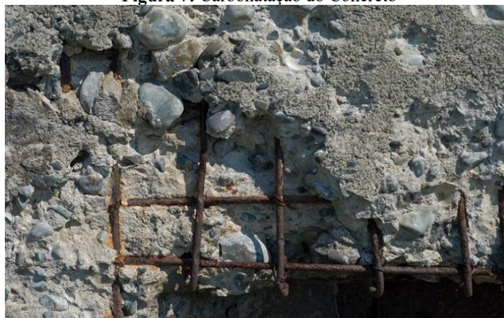
Figura 7: Carbonatação do Concreto
