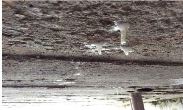
Figura 4: Lixiviação: Estalactites em fundo de caixa d'água
