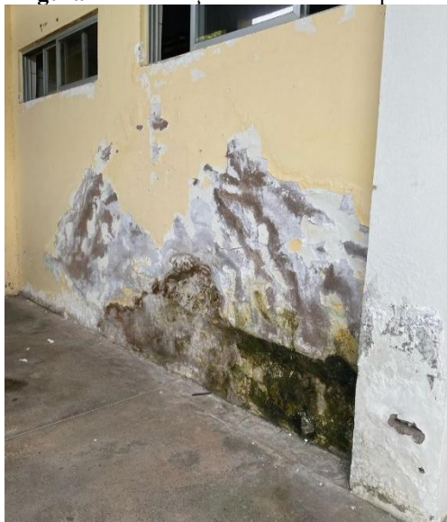
Figura 11: Infiltração ascendente em parede
