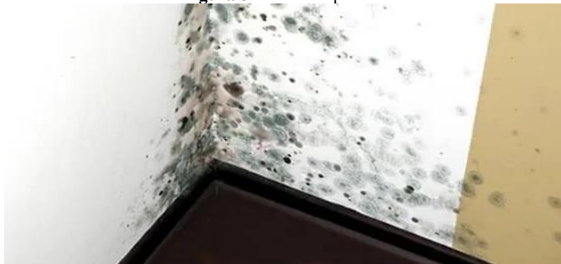
Figura 5: Bolor em paredes
