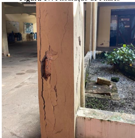
Figura 17: Fissuração de Pilares
