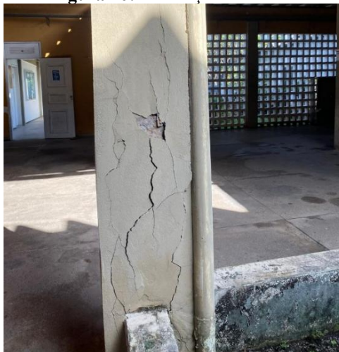
Figura 16: Fissuração de Pilares
