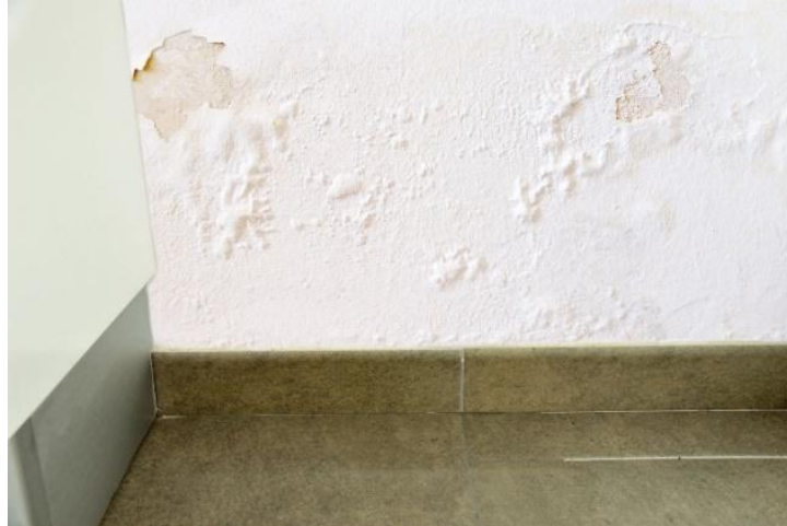
Figura 1: Infiltração em parede
