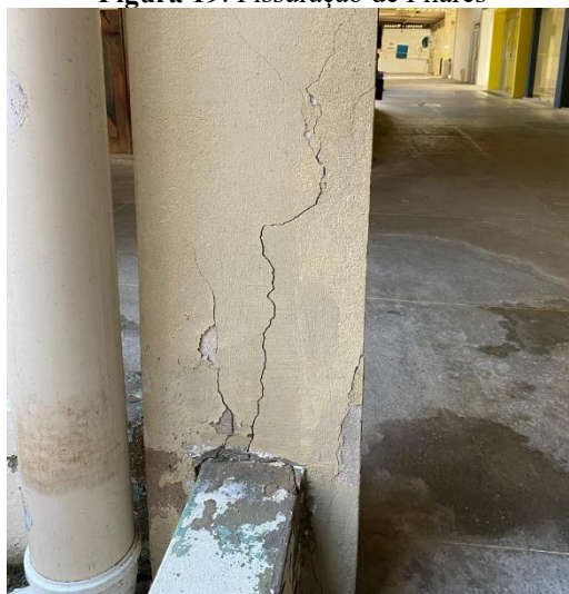
Figura 19: Fissuração de Pilares
