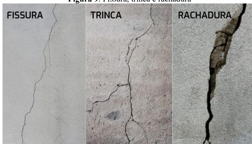
Figura 9: Fissura, trinca e rachadura
