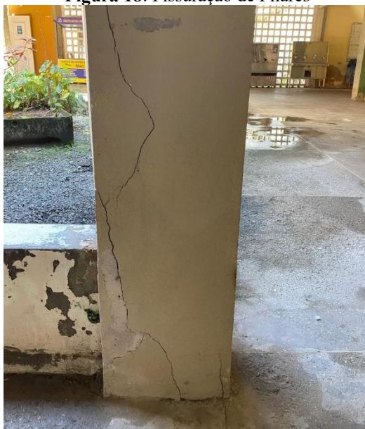
Figura 18: Fissuração de Pilares
