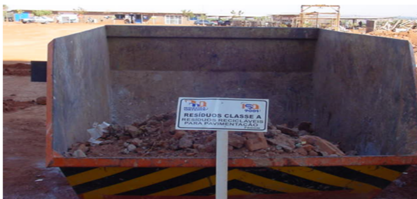
Figura 13 – Contêiner para resíduos Classe A
