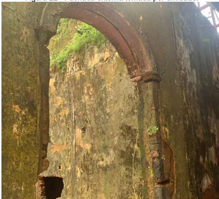
Figura 22 - Fachada externa tomada por umidade.
