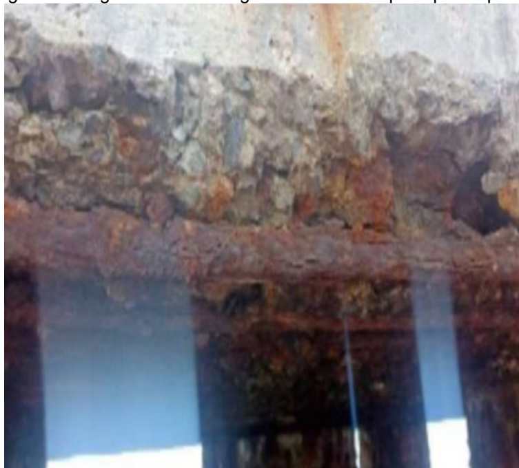
Figura 9 - Região inferior de viga com armadura principal exposta.
