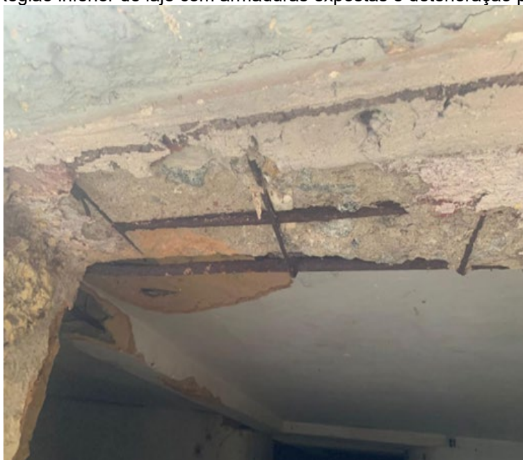
Figura 10– Região inferior de laje com armaduras expostas e deterioração por infiltração.
