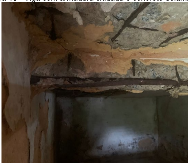
Figura 13 - Viga com armadura oxidada e concreto delaminado.
