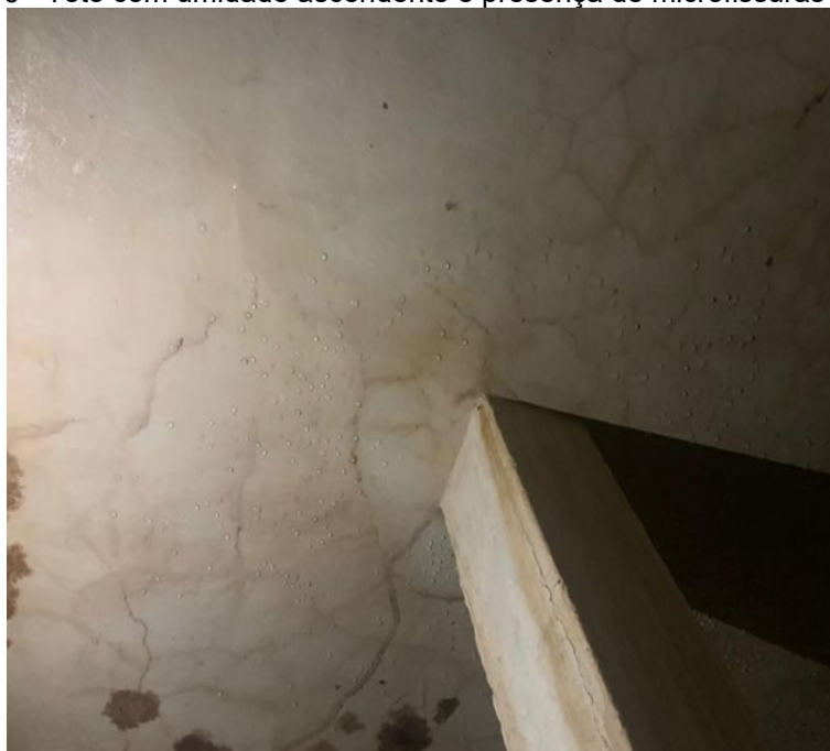
Figura 16 - Teto com umidade ascendente e presença de microfissuras e bolhas.
