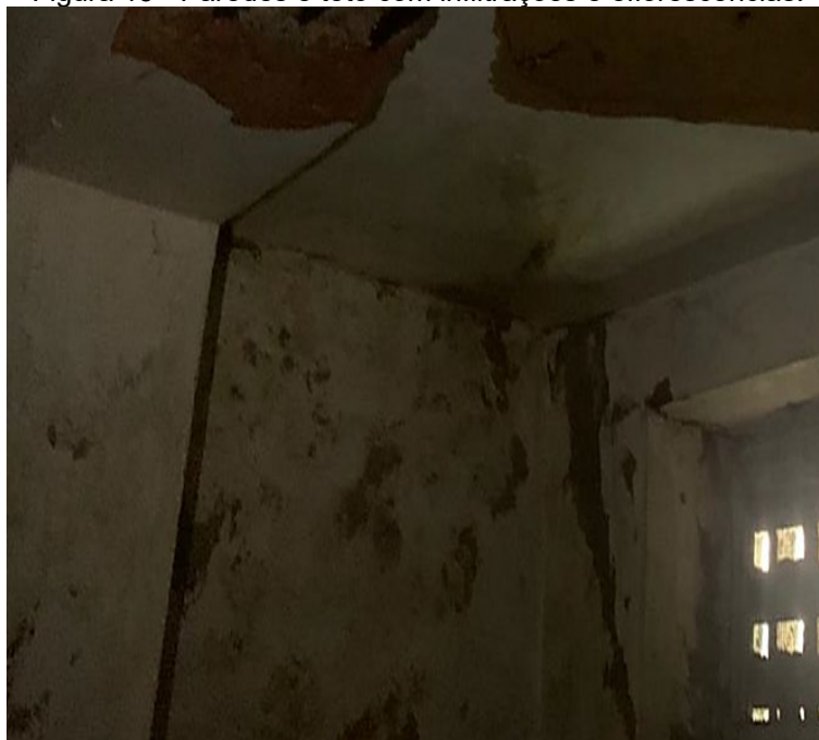
Figura 15 - Paredes e teto com infiltrações e eflorescências.
