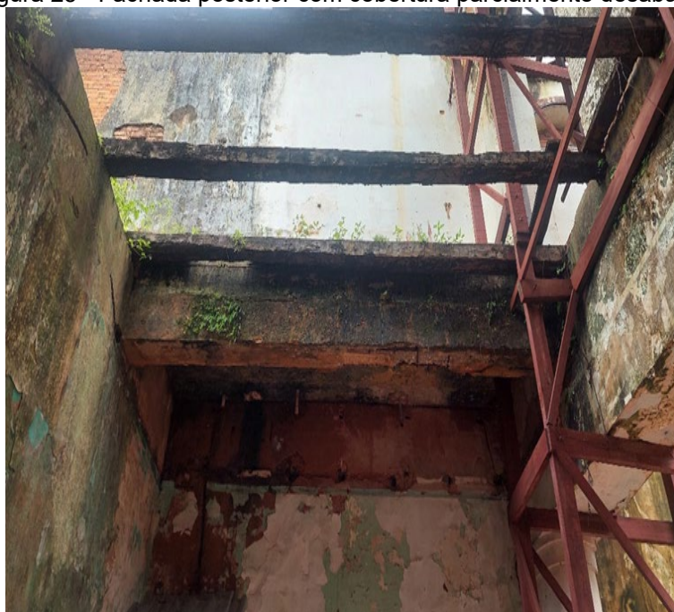
Figura 25 - Fachada posterior com cobertura parcialmente desabada.
