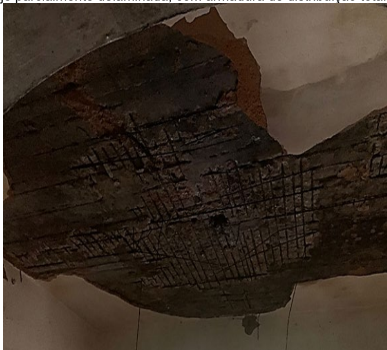
Figura 17 - Laje parcialmente delaminada, com armadura de distribuição totalmente exposta.
