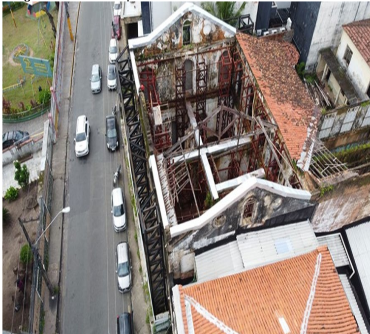
Figura 26 - Vista superior da cobertura totalmente destruída.
