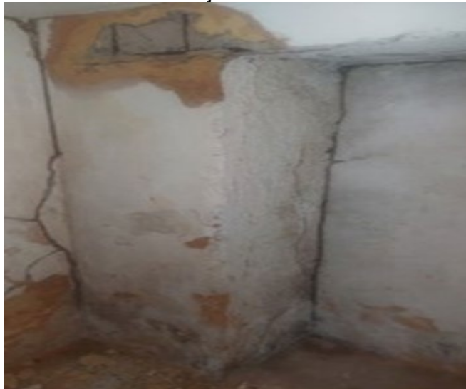
Figura 12 - Pilar com fissuração vertical e manchas de umidade.
