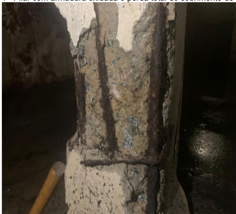
Figura 14 - Pilar com armadura oxidada e perda total do cobrimento de concreto.
