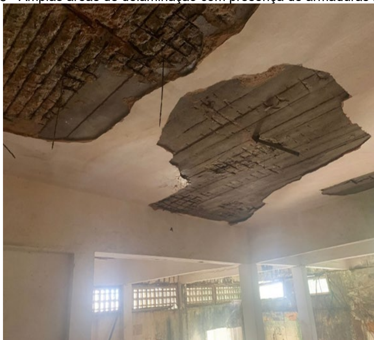
Figura 18 - Amplas áreas de delaminação com presença de armaduras rompidas.
