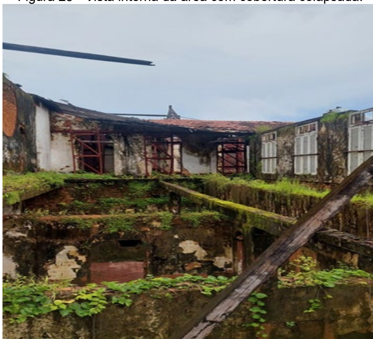
Figura 23 - Vista interna da área com cobertura colapsada.
