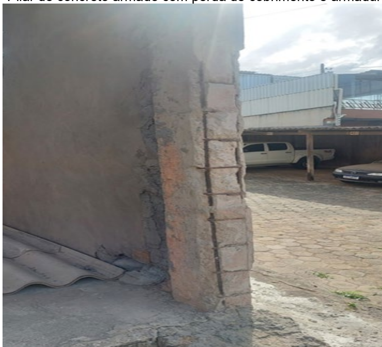
Figura 7 - Pilar de concreto armado com perda de cobrimento e armadura exposta.
