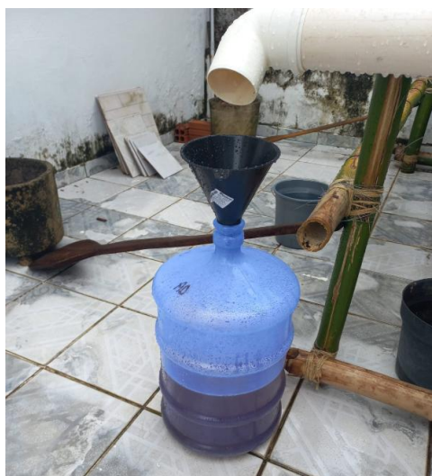
Figura 19 - sistema de armazenamento da água da chuva
