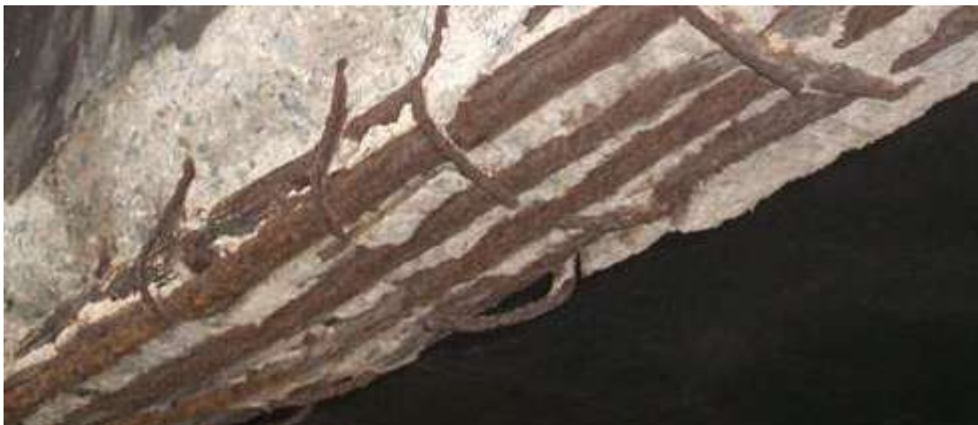
Figura 1 - Corrosão em barras de aço
