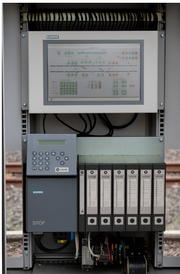
Figura 15 – Equipamento EletrologIXS dentro do TU, Modelo gerado por IA.
