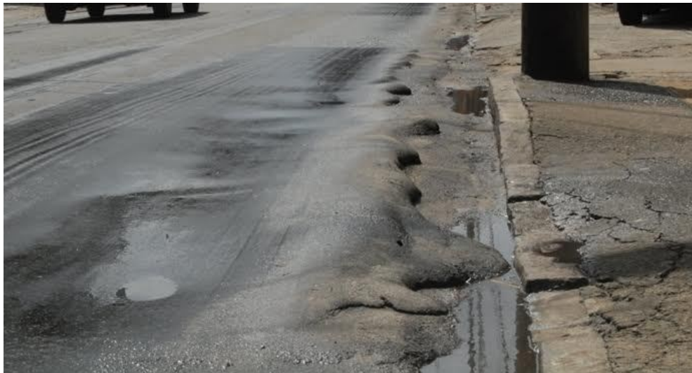
Figura 2: Ondulação ou Corrugação
