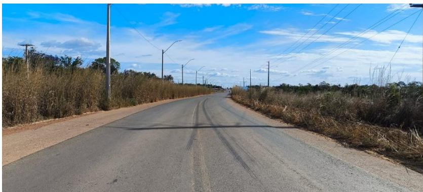
Figura 11 - Desgaste e na sinalização horizontal e inexistência de sinalização vertical
