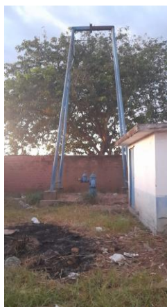
Figura 8 – Captação subterrânea através de poços em Balsas – MA
