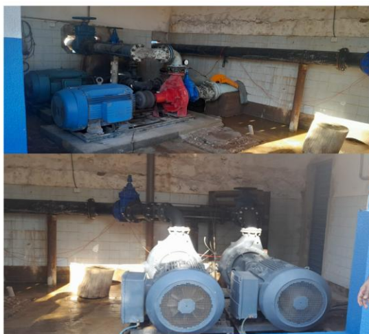
Figura 7– Bombas de pressurização na estação de tratamento de água de Balsas – MA
