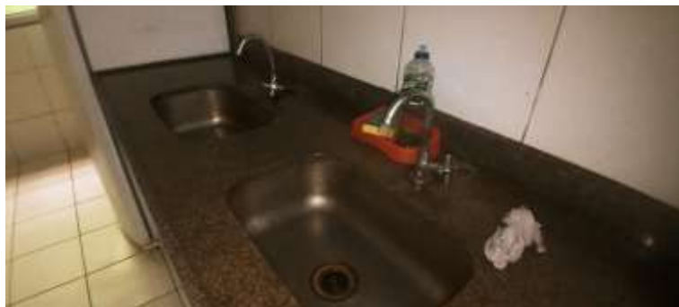
Imagem 15: Torneira na copa do prédio central
