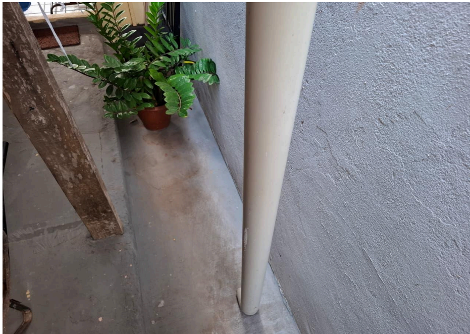
Figura 5: Condutor vertical de água pluvial em PVC
