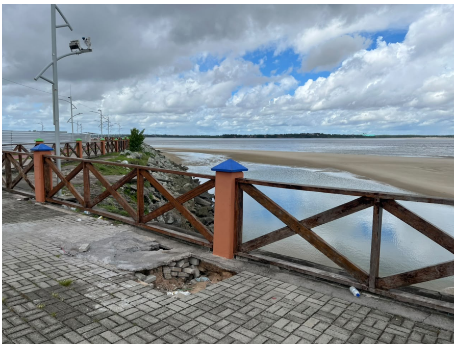
Figura 26: Registro erosão no calçadão da Ponta d'Areia.
